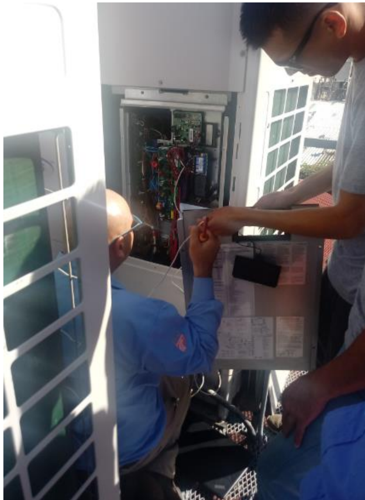
Figura 8.9 Visita de mantenimiento de aires acondicionados
