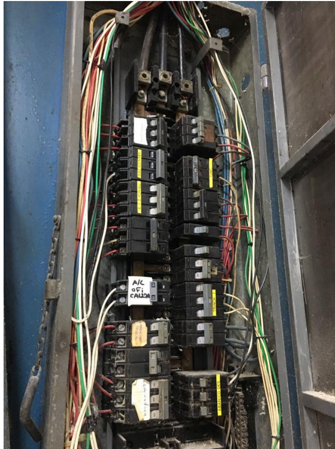
Figura 3.5 Tablero con disyuntores sin uso
