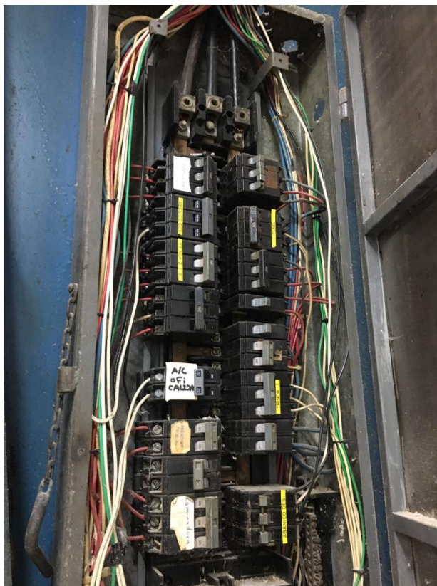
Figura 3.13 Tablero con mal código de colores en líneas
