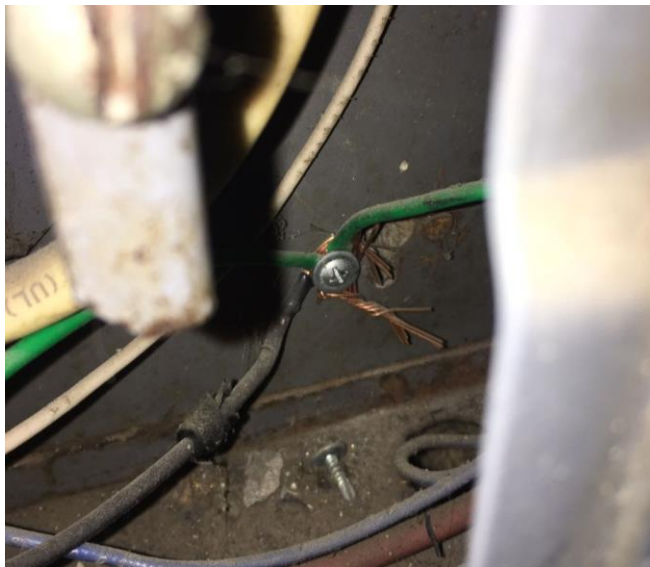
Figura 3.22 Tablero sin barra de tierras
