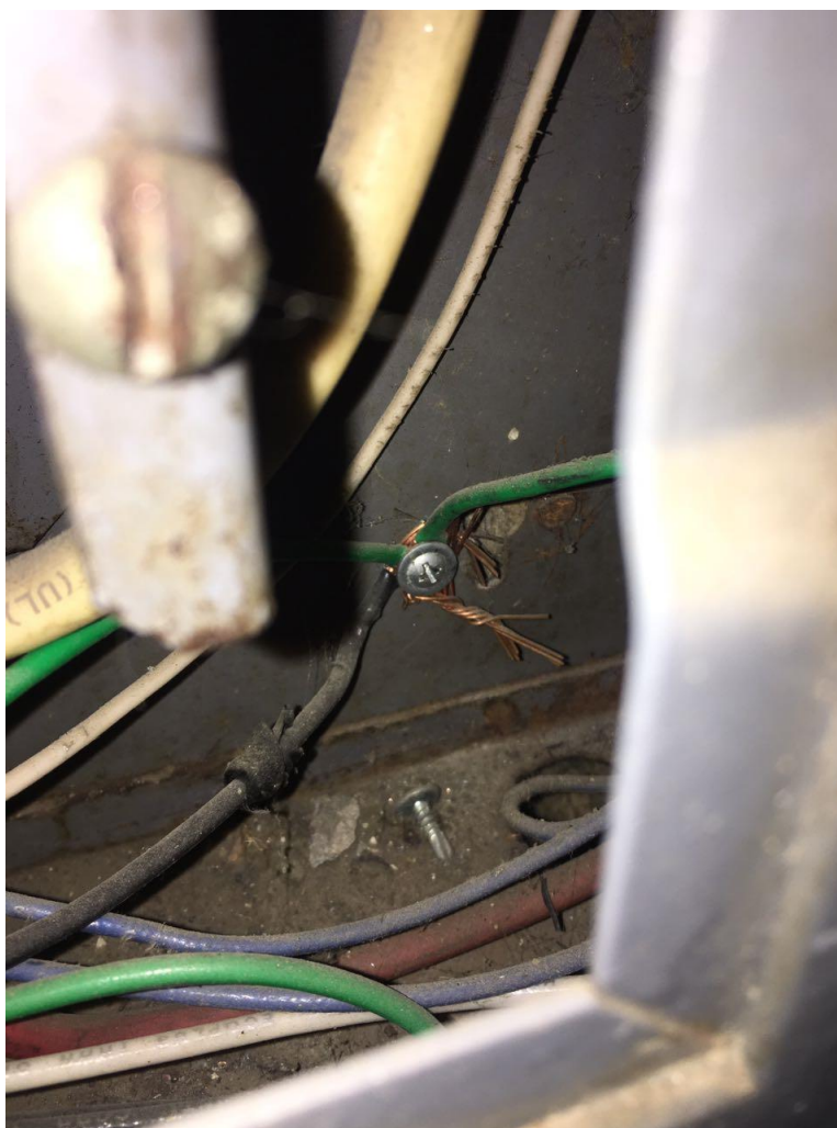
Figura 3.15 Tablero sin barra de tierras
