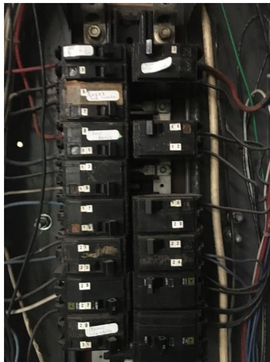
Figura 3.6 Disyuntores tablero CP
