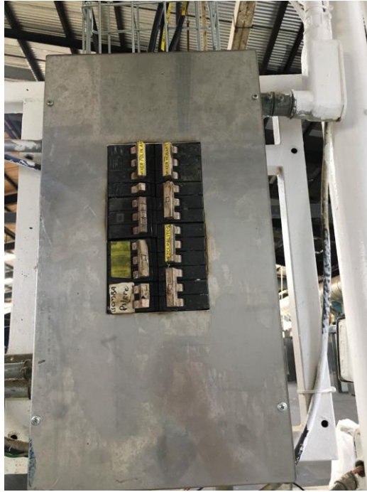
Figura 3.9 Tablero con debida tapa
