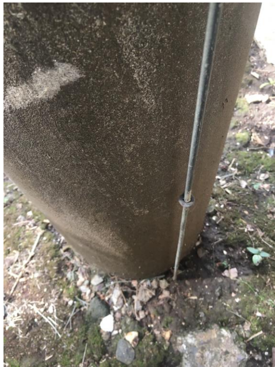
Figura 3.21 Tierra transformador acometida 2
