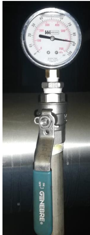
Figura 30 Método de Medición de la caída de Presión en la línea de líquidos de Gobierno y Conservas.
