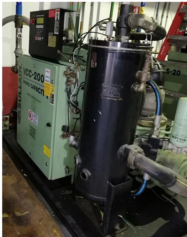
Figura 9 Compresor de aire de capacidad variable
