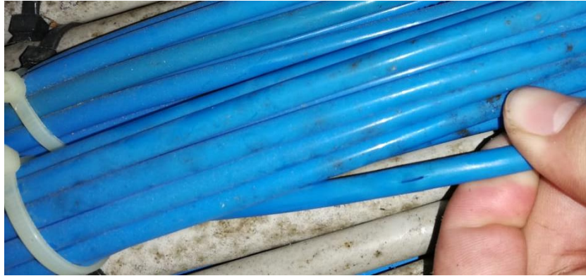
Figura 53 Fuga en las mangueras de aire comprimido para cocinadores en la pasarela
