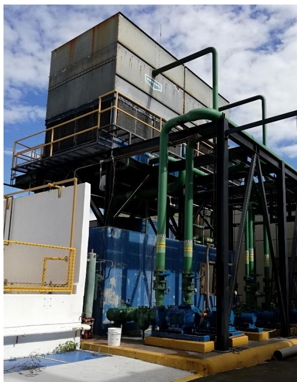
Figura 11 Torre de enfriamiento evapco
