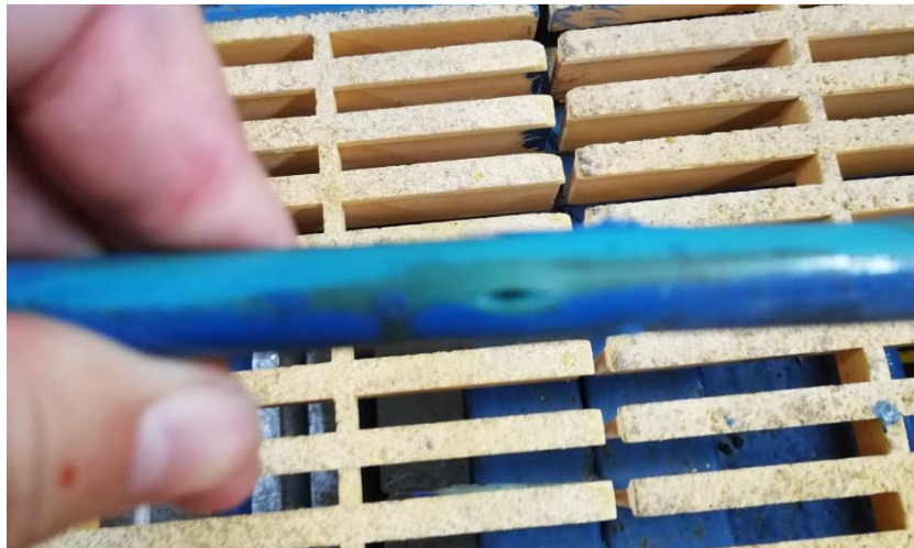
Figura 52 Fuga de aire comprimido en la pasarela de descongelado de atún
