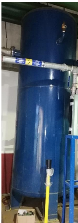
Figura 13 Tanque de Almacenamiento de aire comprimido
