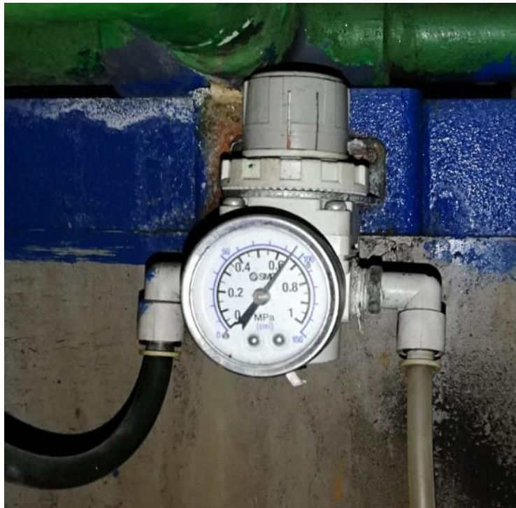
Figura 54 Fuga en manómetro ubicado en el cuarto de calderas
