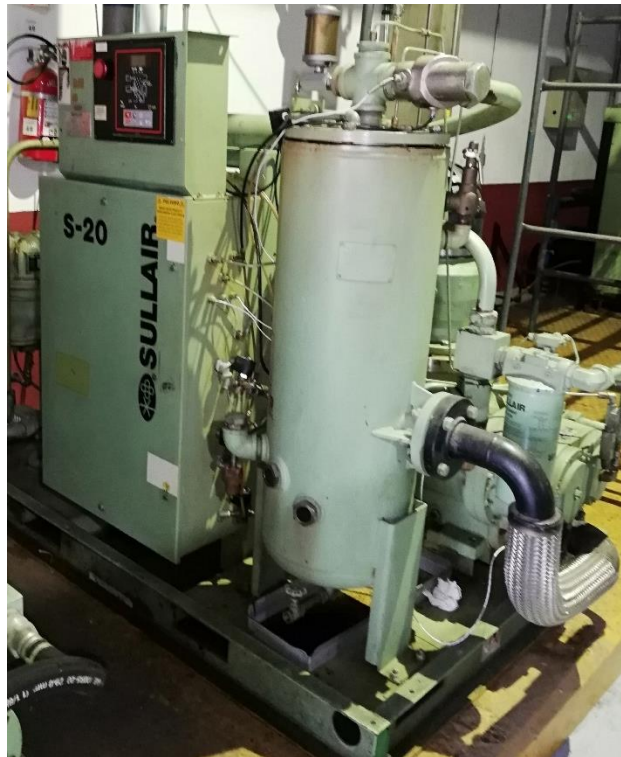
Figura 10 Compresor de aire de carga y descarga
