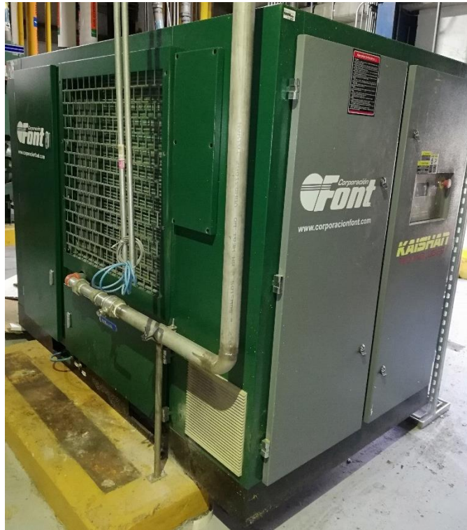
Figura 15 Compresor de aire con variador de frecuencia
