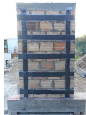
Figura 11. Esquema de colocación del FRP tanto para esfuerzos de flexión como de cortante Fuente. Tomado de Vega Vargas (2015).
