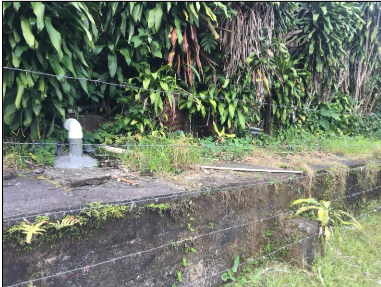
Figura 0.3. Conexiones para descarga de aguas residuales por tubo de PVC al canal de Hidroeléctrica Matamoros, Calle Linares, Ciudad Quesada.
