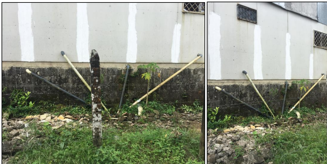
Figura 0.4. Conexiones para descargas directas de aguas residuales al canal subterráneo de Hidroeléctrica Matamoros, Calle Linares, Ciudad Quesada.
