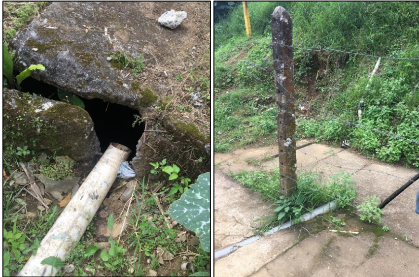
Figura 0.5. Conexiones para descarga de aguas residuales al canal de Hidroeléctrica Matamoros, Calle Linares, Ciudad Quesada.
