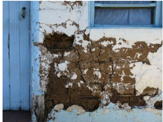
Imagen C2.50. Sistema constructivo expuesto de vivienda en abandono. Fuente: propia.
