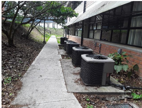
Figura 4.9 Acumulación de hojas alrededor de los condensadores.
