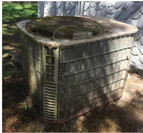
Figura 4.11. Unidad condensadora abandonada.
