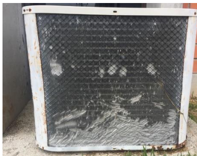
Figura 4.8 Unidad condensadora en malas condiciones.
