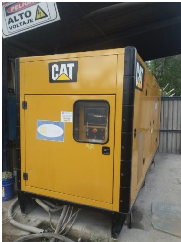
Figura 13. Planta eléctrica Fuente. Fotografía tomada el 13/03/2019
