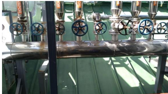
Figura 4.3. Manifold para diferentes unidades del hospital
