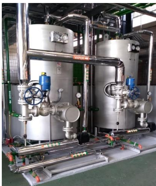
Figura 4.7. Tanques de agua caliente rehabilitación
