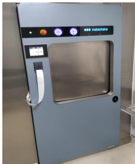
Figura 4.9. Autoclave del área de centro de equipos, marca Matachana
