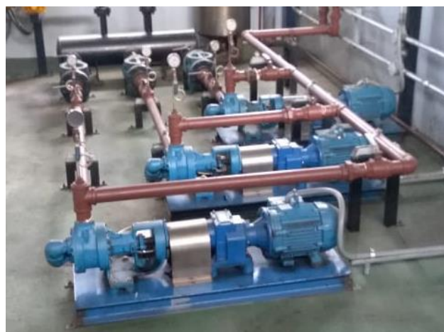
Figura 4.4. Motores eléctricos y bombas de la estación de búnker
