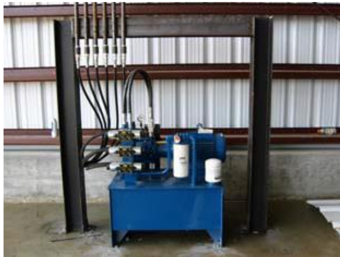
Figura 6.6. Fotografía del Sistema hidráulico
