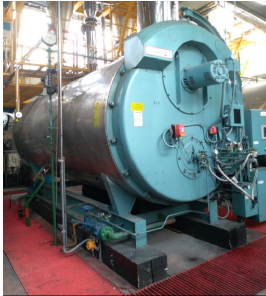
Figura 4.1. Caldera de 300 HP
