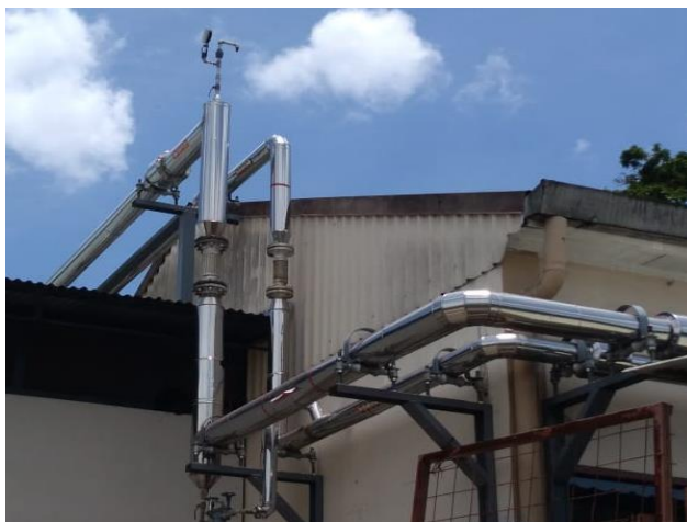
Figura 4.5. Tuberías de distribución para unidades de Nutrición
