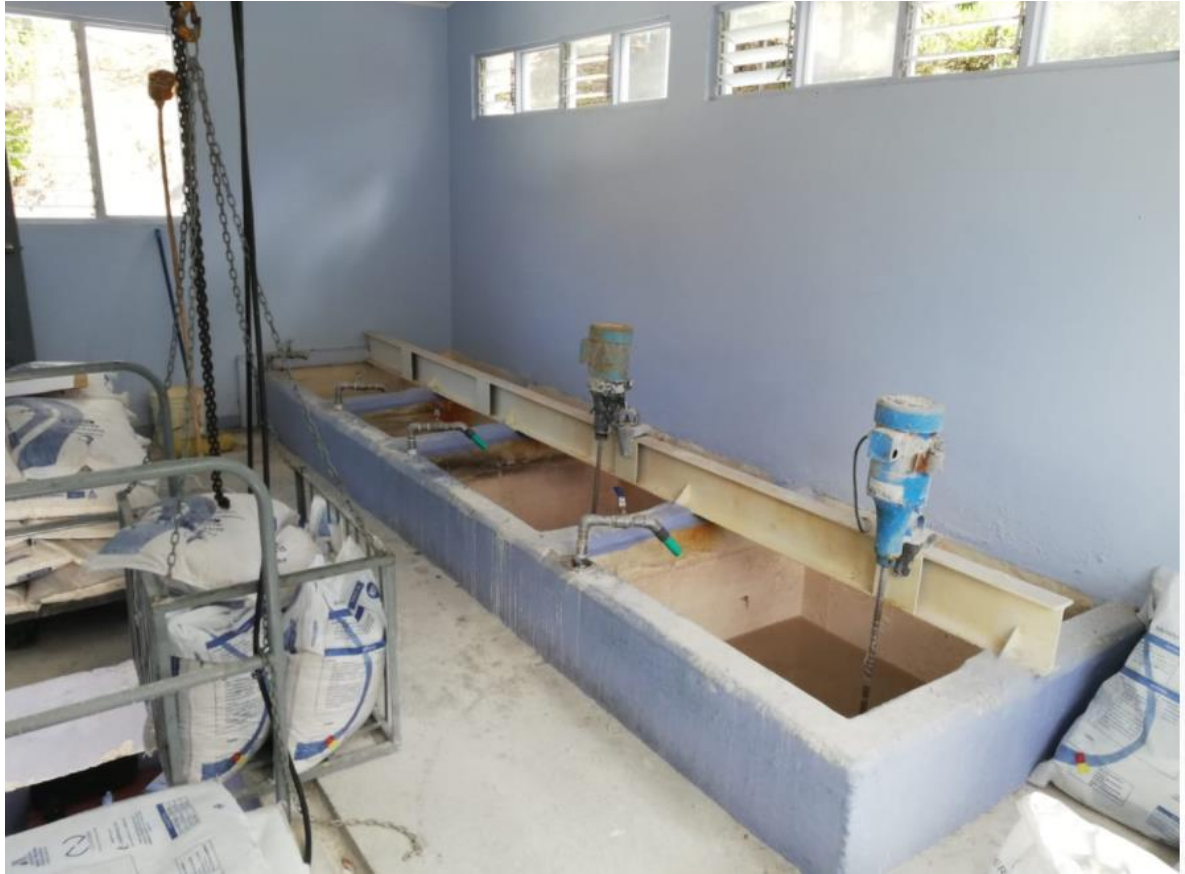
Figura 5-22. Cuarto de agitadores de sulfato.
