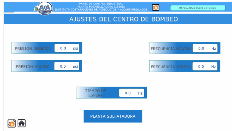
Figura 6-12. Ajustes del centro de bombeo.
