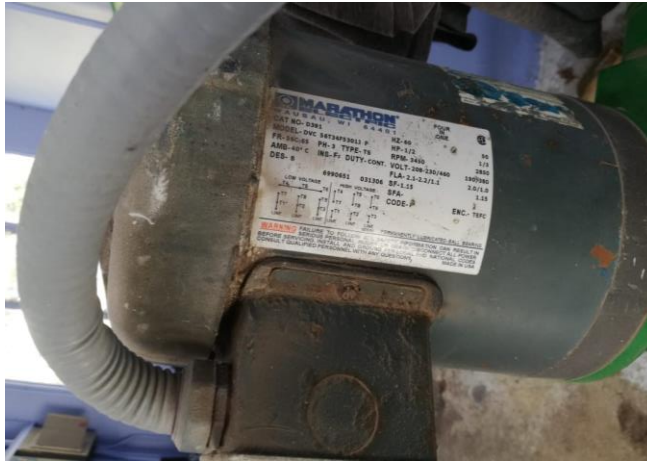
Anexo 40. Dato de placa del motor 1 y 2 del panel de dosificadoras de sulfato.
