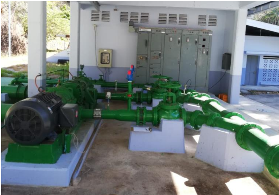
Figura 4-5. Sistema de control y potencia del sistema de bombeo de la Planta Potabilizadora de Liberia.
