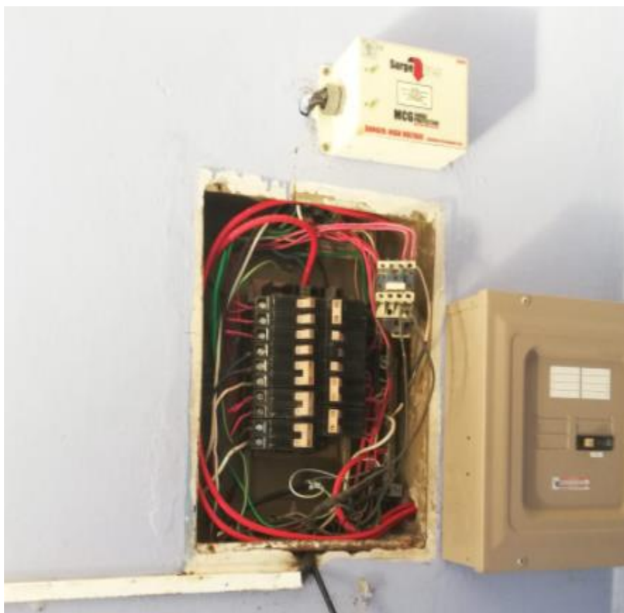
Figura 4-9. Tablero eléctrico de la planta sulfatadora de la Planta Potabilizadora de Liberia.
