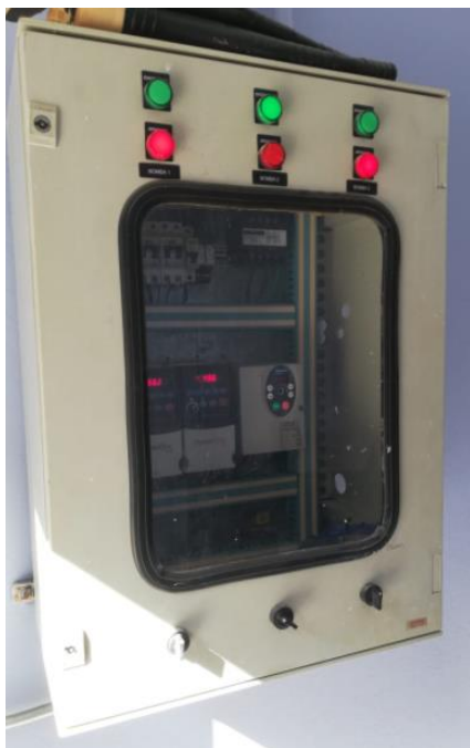
Figura 4-7. Panel de control de las bombas dosificadoras de sulfato.
