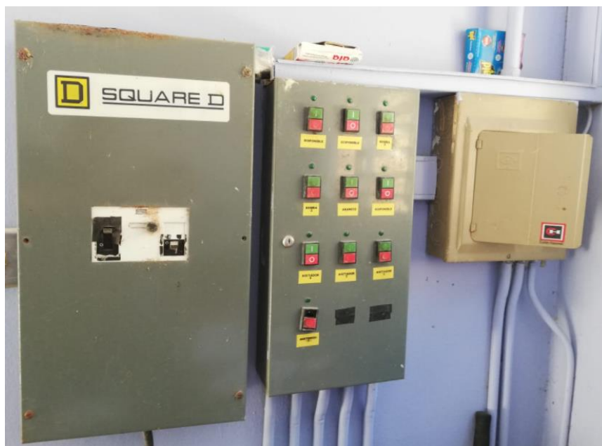
Figura 4-8. Panel de control de los motores agitadores de sulfato.
