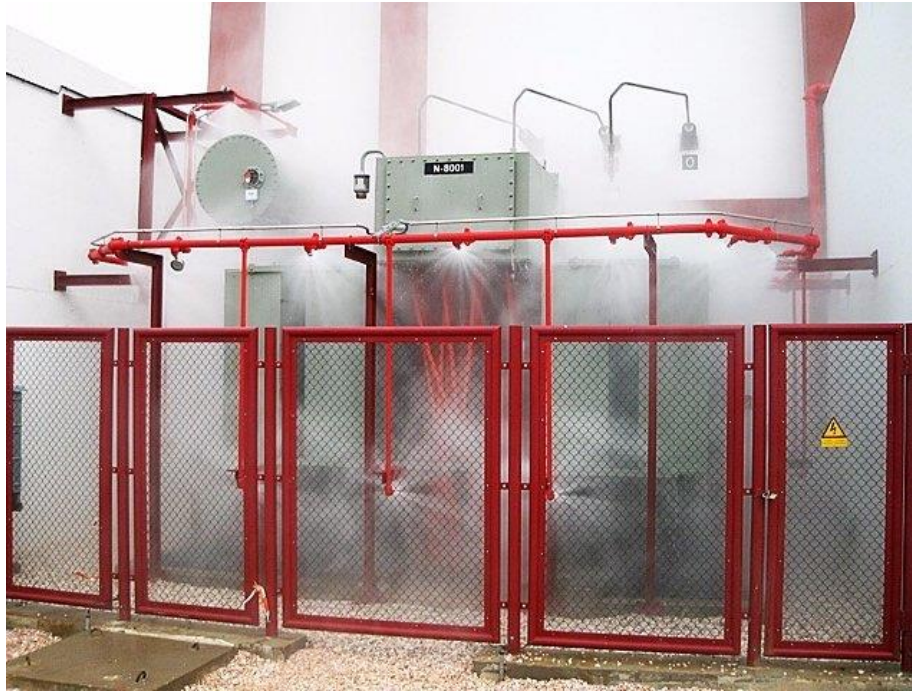
Figura 54. Sistema de rociadores automáticos para la subestación del Plantele de Barrio Fátima
