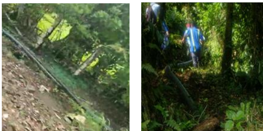
Figura 5.5. Tubería de conducción de la ASADA de Suerre
