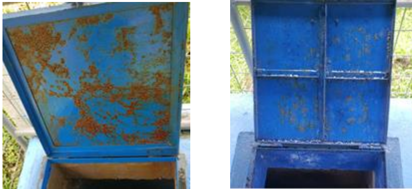
Figura 5.6. Tapas de los tanques quiebra gradientes del sistema F1 Suerre herrumbradas
