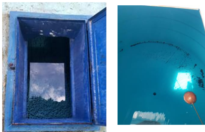
Figura 5.4. Tanques de almacenamiento del sistema F1 Suerre con sedimentos
