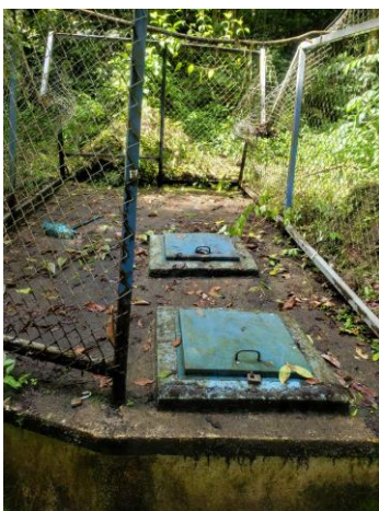
Figura 5.3. Cerramiento de la estructura de captación F2 Calle Uno Tablón dañado
