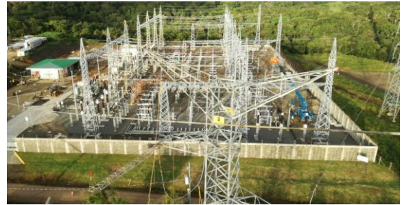
Figura 9. Sub Estación Eléctrica Orosi. Fuente: DICOMA Construcción.
