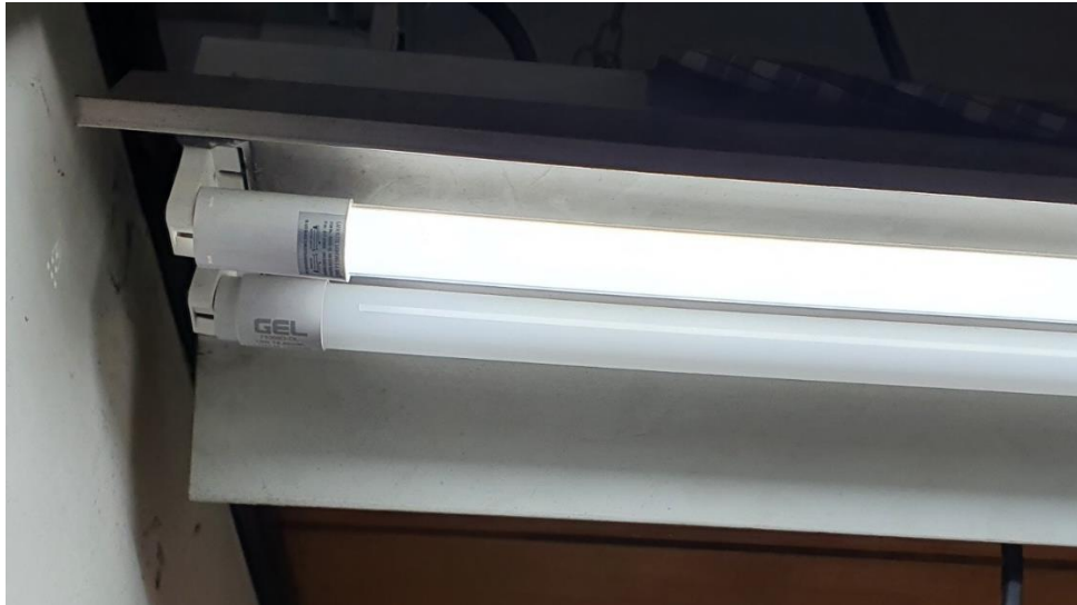
Figura 64. Luminarias con polvo en los lados internos.
