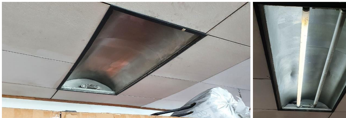
Figura 65. Luminarias sin lámparas o dañadas en el área de corte.
