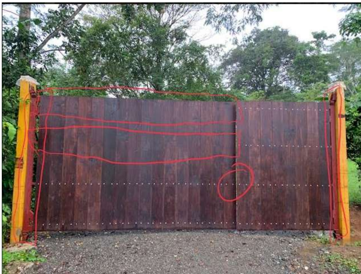
(b) Portón con acabado de tablilla y remaches incompleto. Fuente: Grupo Constructora JDD Ltda.
