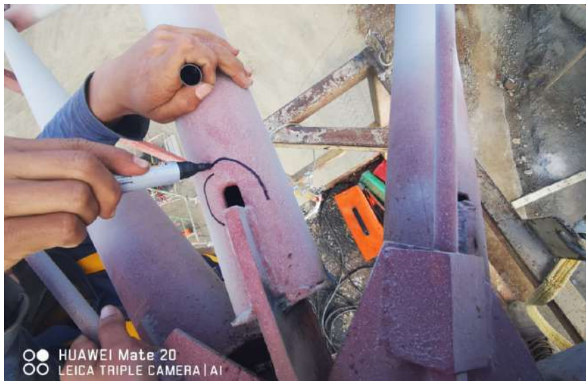
(c) Hendiduras en unión de placas de los tubos de hierro con la estructura. Fuente: CONICO, 2022.
