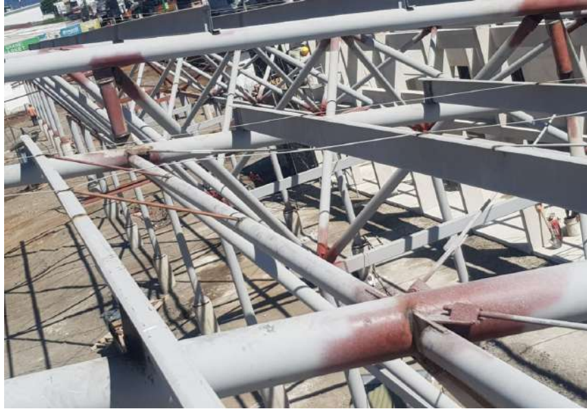
(b) Sistema de apuntalamiento de clavadores incorrecto. Fuente: CONICO, 2022.
