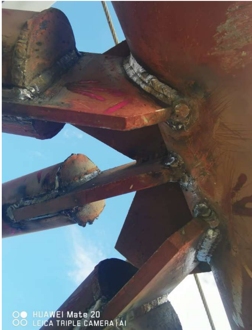
(a) Acabados en tapas de tubos inaceptables y unión defectuosa de placa Fuente: CONICO, 2022.
