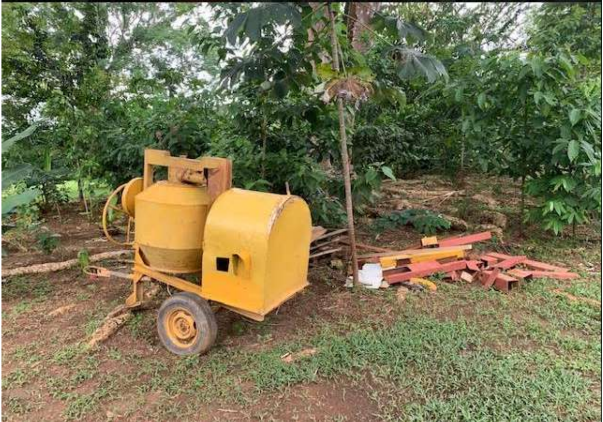
(e) Materiales de desecho sin su debida disposición y equipo sin retirar del sitio. Fuente: Grupo Constructora JDD Ltda.
