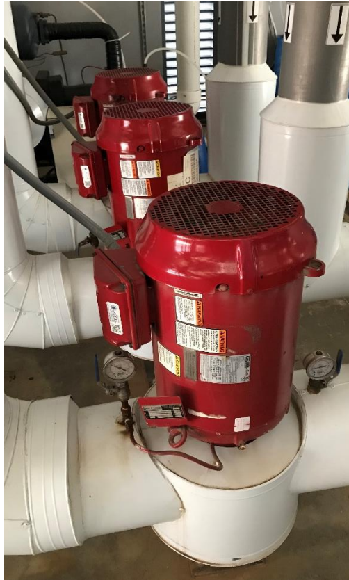
Figura 16. Unidad de bombeo de agua helada Fuente: Elaboración propia (2022).
