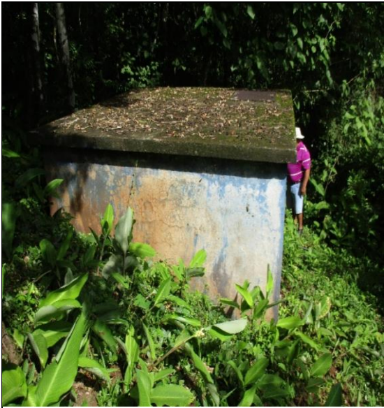
Foto 1. Tanque de almacenamiento la Paulona.
