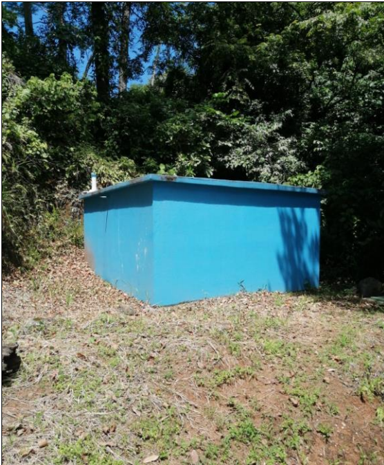
Foto 1. Tanque de almacenamiento los Abarca.
