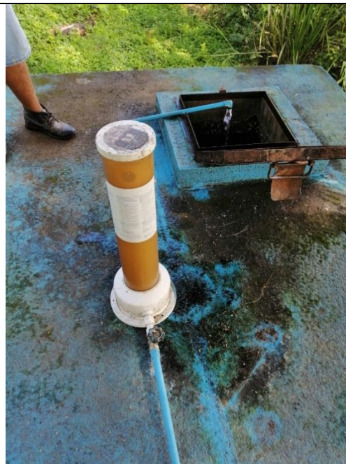
Foto 2. Entrada al tanque del caudal del clorador.
