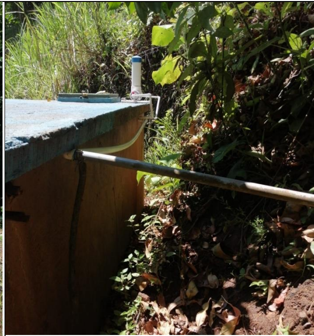
Foto 2. Tubería de entrada al tanque los Abarca.
