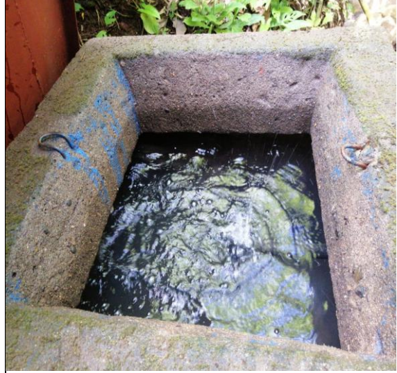
Foto 4. Vista superior del tanque de reunión, se puede observar el nivel de agua.
