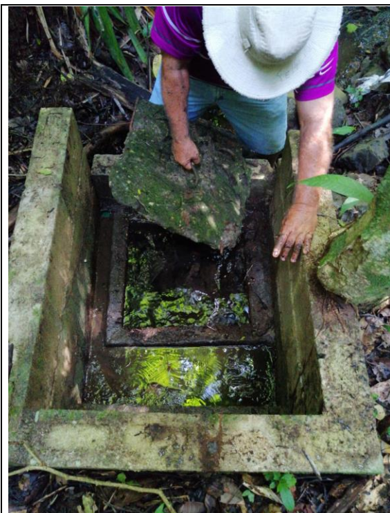
Foto 1. Tapa y estructura de captación.
