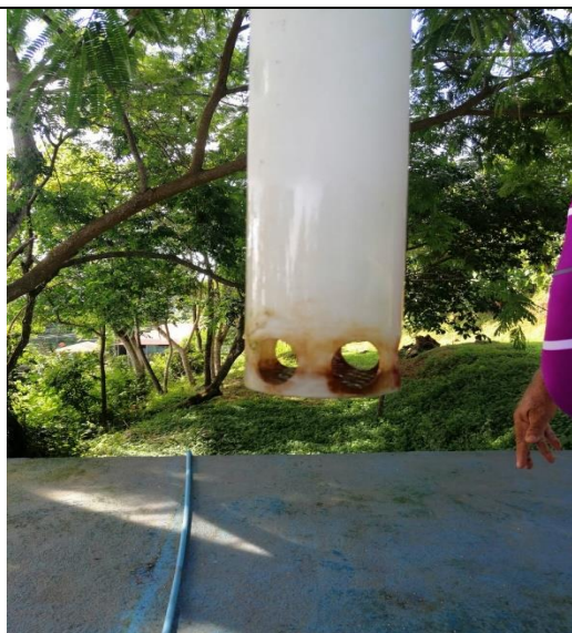
Foto 3. estructura interna del clorador
