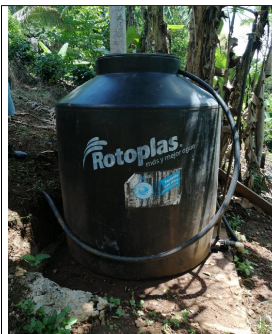
Foto 1. Tanque de almacenamiento los Vargas, se puede observar la tubería de entrada y el planché de cemento en el que está ubicado.
