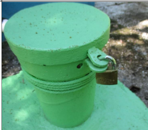
Foto 4. Candado se seguridad en el pozo.
