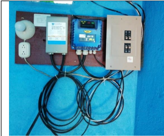
Foto 5. Panel de control del pozo.
