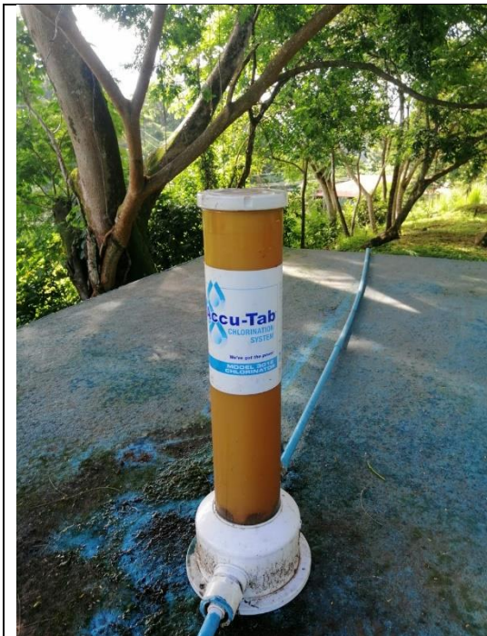
Foto 1. Clorador del tanque la plaza.
