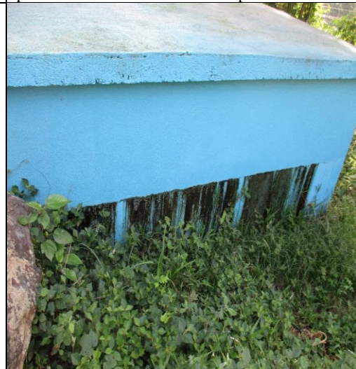
Foto 4. Lana de humedad provocada por la grieta en el tanque.
