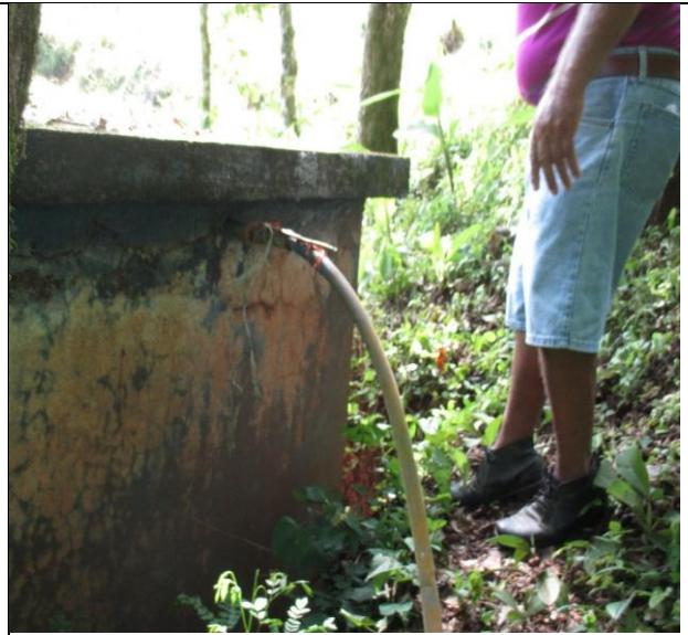
Foto 2. Tubería de entrada al tanque del caudal de agua que proviene de la naciente la Paulona.
