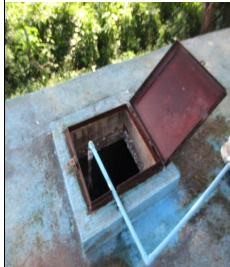
Foto 2. Tapa del tanque, se ve el ingreso de la tubería donde se realiza la cloración. Se dificulta observar la entrada de caudal al tanque por la posición donde esta ubicada la tapa.
