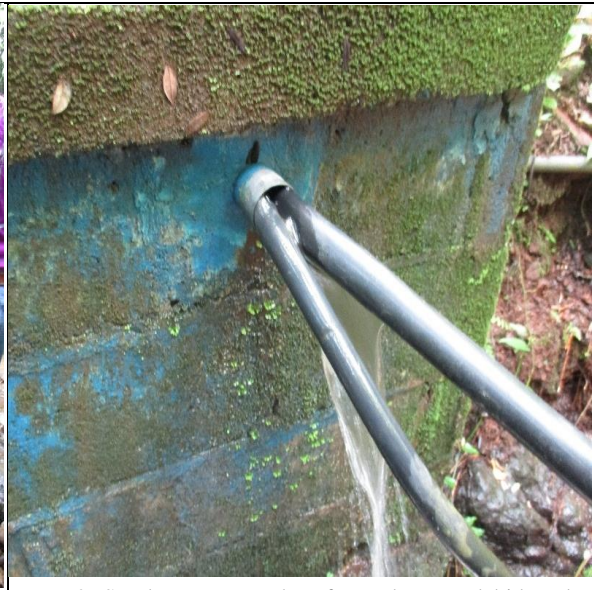
Foto 2. Se observa como hay fugas de agua debido a la mala conexión de tuberías.
