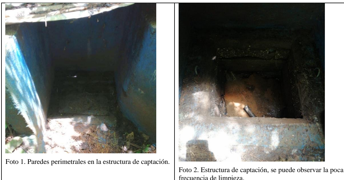
Figura 5.5 Fotos de la estructura de captación de la naciente Abarca 2. Fuente: elaboración propia.
