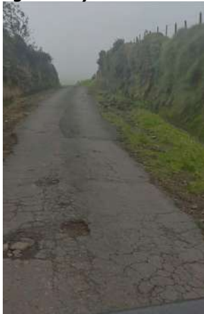
Figura 13 y 14. Estado de las carreteras.
