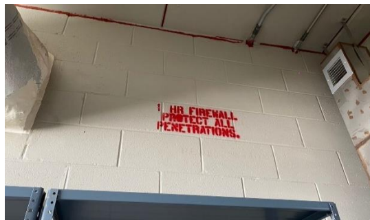
Figura 24. Pared con resistencia al fuego por 1 horas del centro de almacenamiento de UCF (Foto tomada por los autores).
