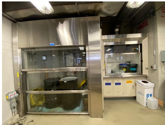
Figura 25. Capillas de extracción de gases del centro de almacenamiento de UCF (Foto tomada por los autores).
