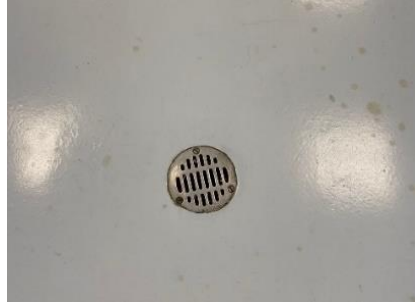
Figura 6. Drenaje presente en el laboratorio de cromatografía de la Escuela de Química (Foto tomada por los autores).
