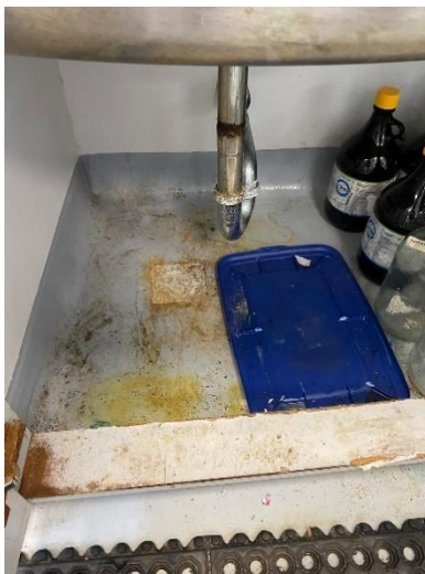
Figura 13. Zona de almacenamiento del laboratorio de Aguas Residuales de la Escuela de Química (Foto tomada por los autores).
