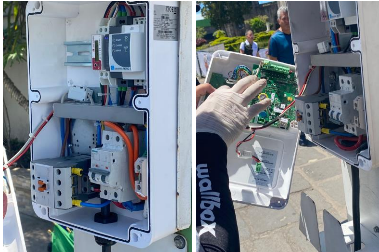
Ilustración 19. Inspección a las estaciones de carga semirrápida
