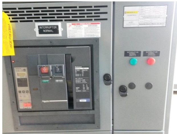
Figura 6.4. Detalle de un interruptor de transferencia eléctrica (Fabián Blanco Piña, 2015)
