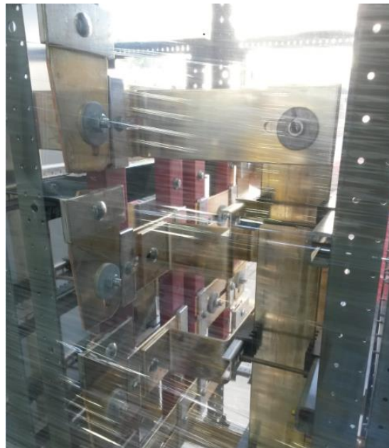
Figura 6.5. Barras de acometida eléctrica (Fabián Blanco Piña, 2015)
