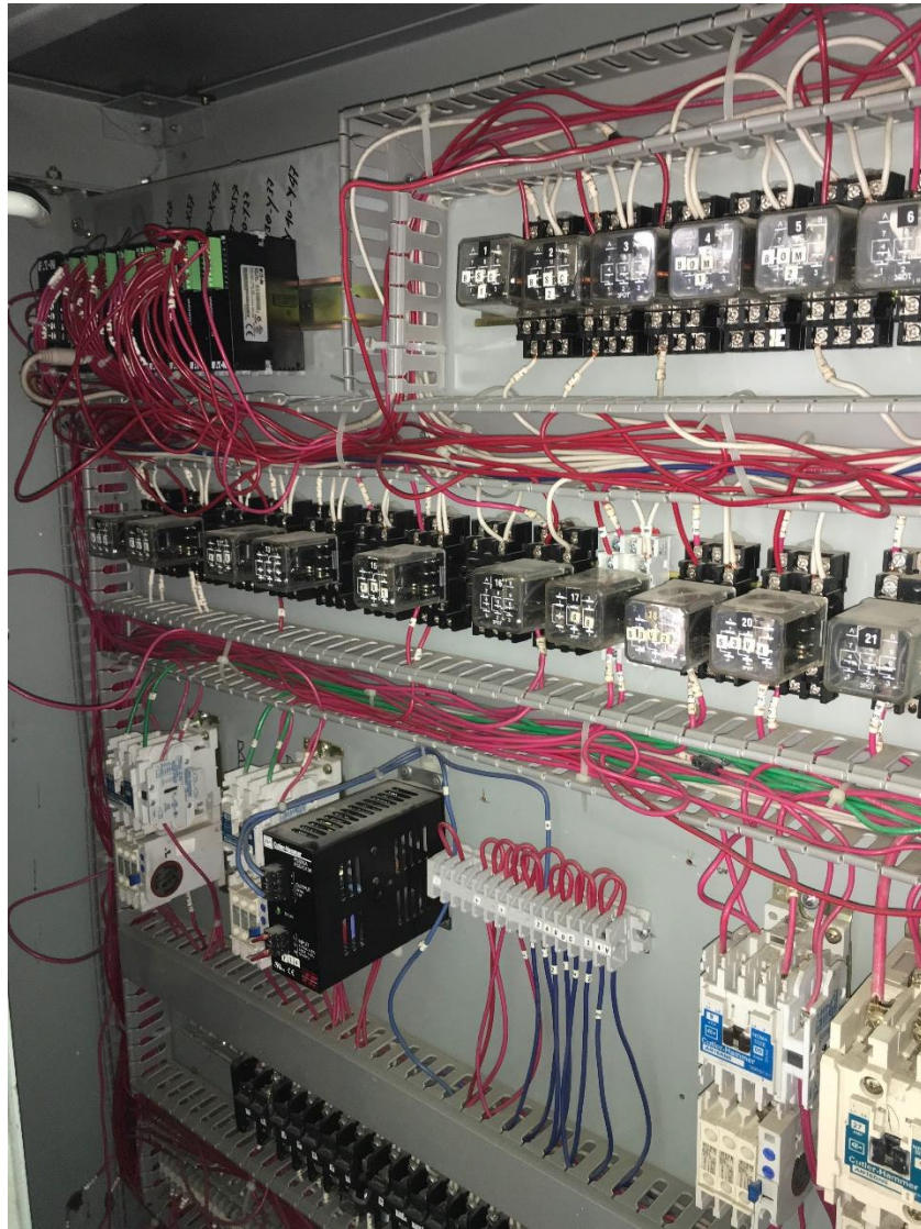
Figura 3.3. Gabinete de control de la planta de tratamiento
