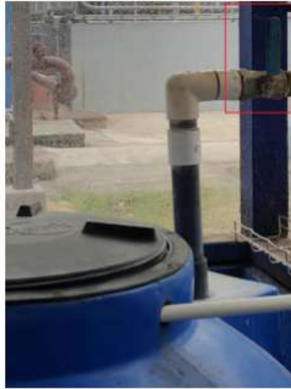
Figura 8. Llave de paso manual de agua
