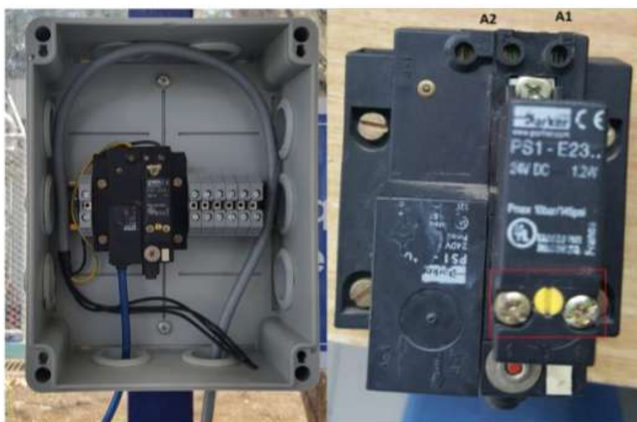
Figura 7. Electroválvula de control de flujo de cloro
