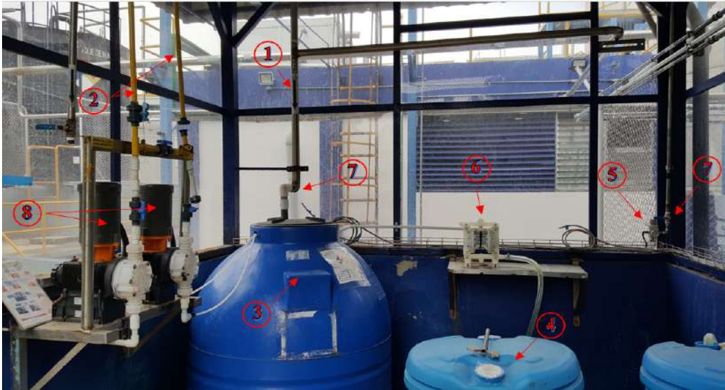
Figura 3.1: Detalle de los elementos disponibles en el cuarto de dosificación de cloro. Fuente: Elaboración propia
