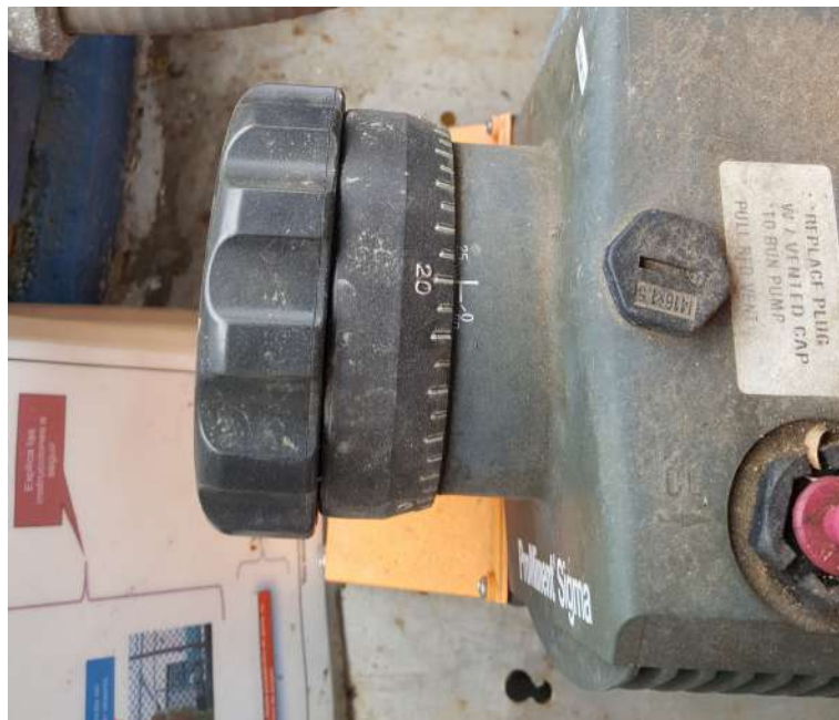
Figura 3.2: Detalle del elemento encargado de la dosificación de las bombas de inyección de mezcla. Fuente: Elaboración propia
