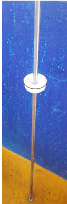
Figura 3.12: Acople para boya de nivel. Fuente: Elaboración propia
