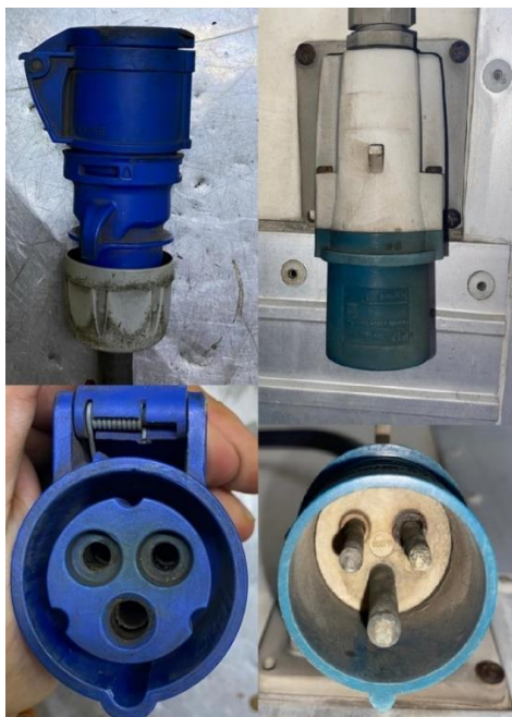
Figura 24. Tipo de conector de 220V presente tanto en el camión (derecha) como en la instalación eléctrica del predio (izquierda).
