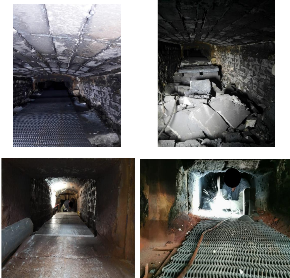
Figura 12. Características del espacio de trabajo en tareas de mantenimiento de horno
