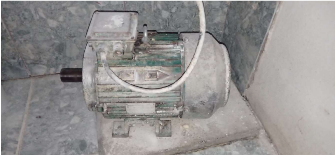
Figura 32. Motor Trifásico bobinado 230 V, 5,5 kW. Utilizado para generar fase fantasma, con eje descubierto.
