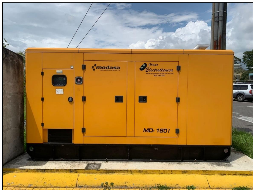
Figura 6.2 Planta de emergencia garantizando suministro eléctrico al edificio y circuitos específicos. Fuente: Elaboración propia.
