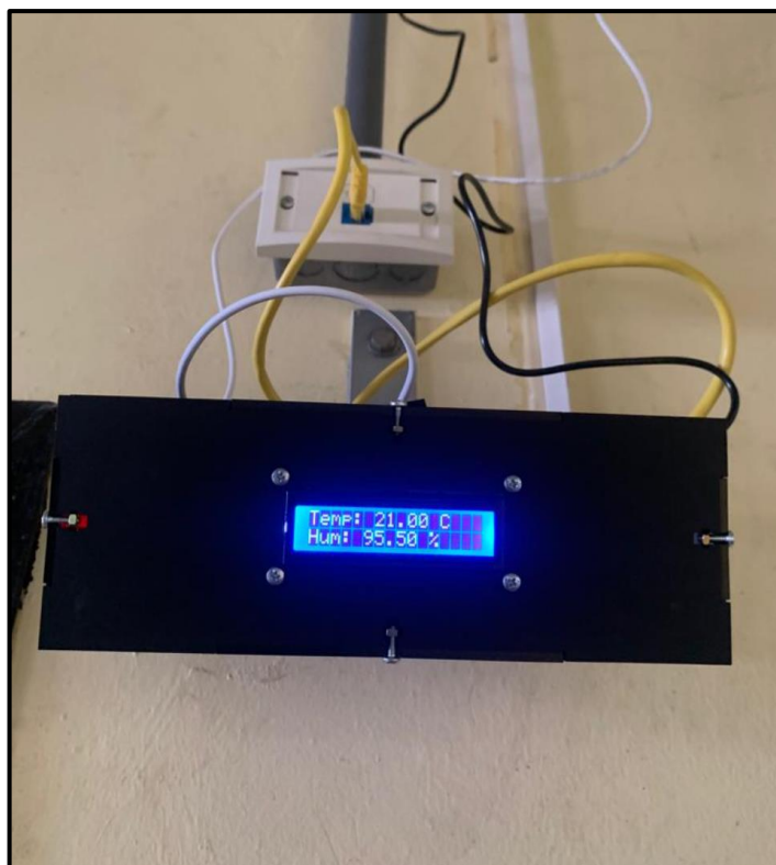
Figura 6.1 Sistema en funcionamiento dentro de las instalaciones del Centro de Investigaciones en Vivienda y Construcción (CIVCO). Fuente: Elaboración propia
