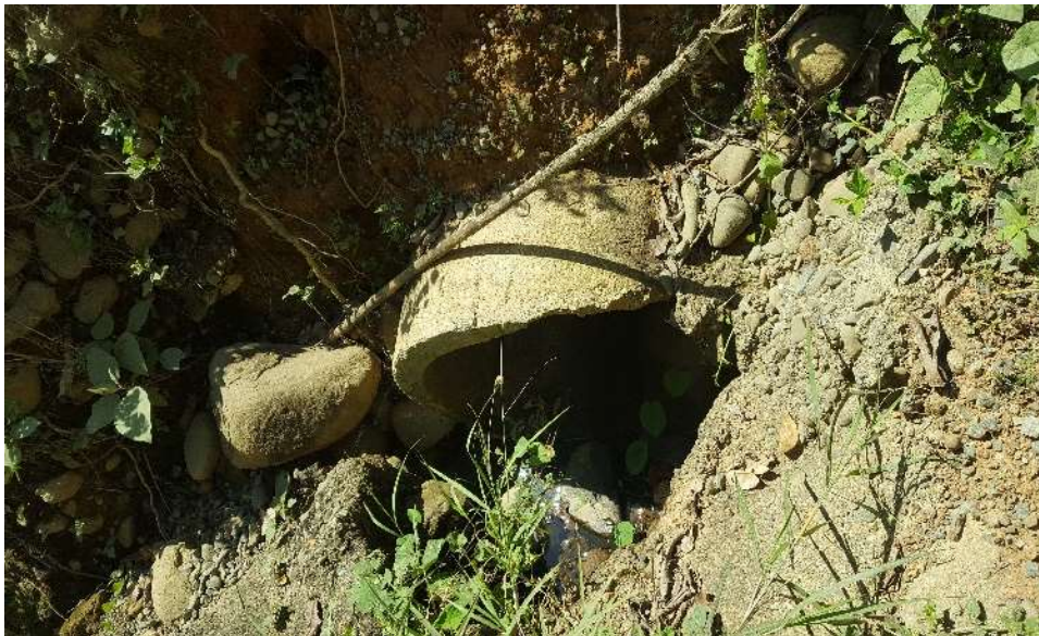
Estado de estructura de drenaje.
