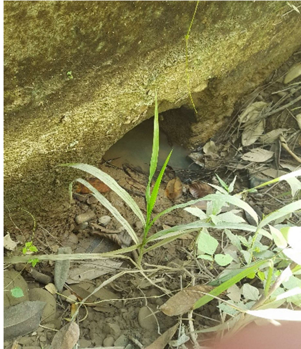
Estado de estructura de drenaje.
