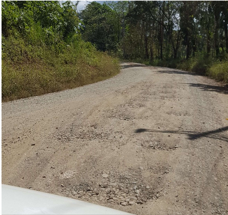
Condición actual de la calzada.
