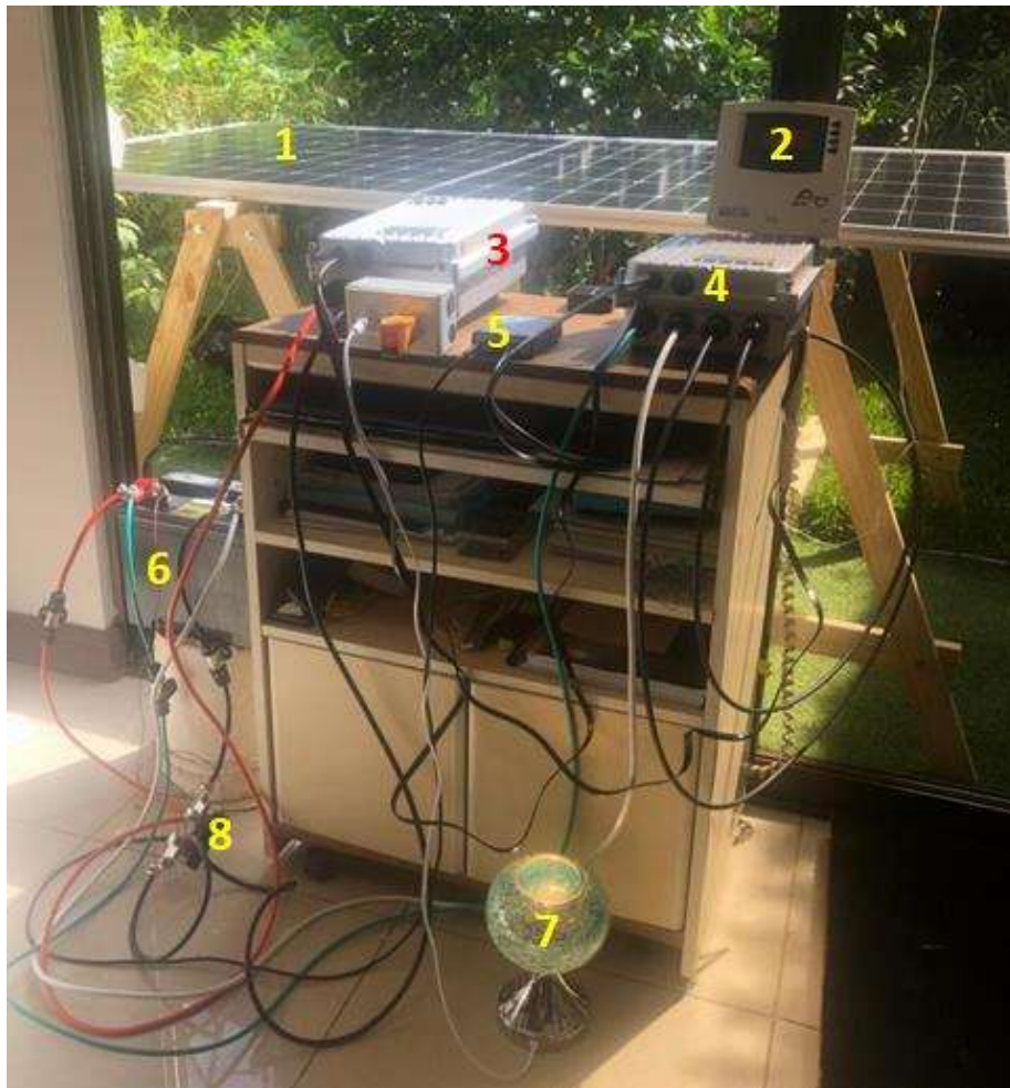
Figura 108. Conjunto inversor híbrido: 1. Panel fotovoltaico, 2. Panel de configuración y monitoreo, 3. Inversor con transferencia incorporada, 4. Controlador de carga, 5. Interface EIA-RS485, 6. Batería 12Vdc 100Ah ciclo profundo, 7. Carga resistiva 40W 120VAC, 8. Medición de corriente de batería,
