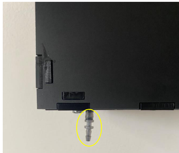
Figura E.1.8. Punta de goteo a remover. Fuente: Elaboración propia
