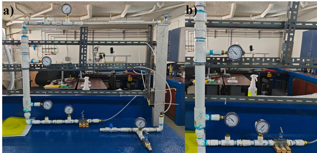
Figura 7. Sistema de filtración del Laboratorio de Materiales Porosos y Celulares
