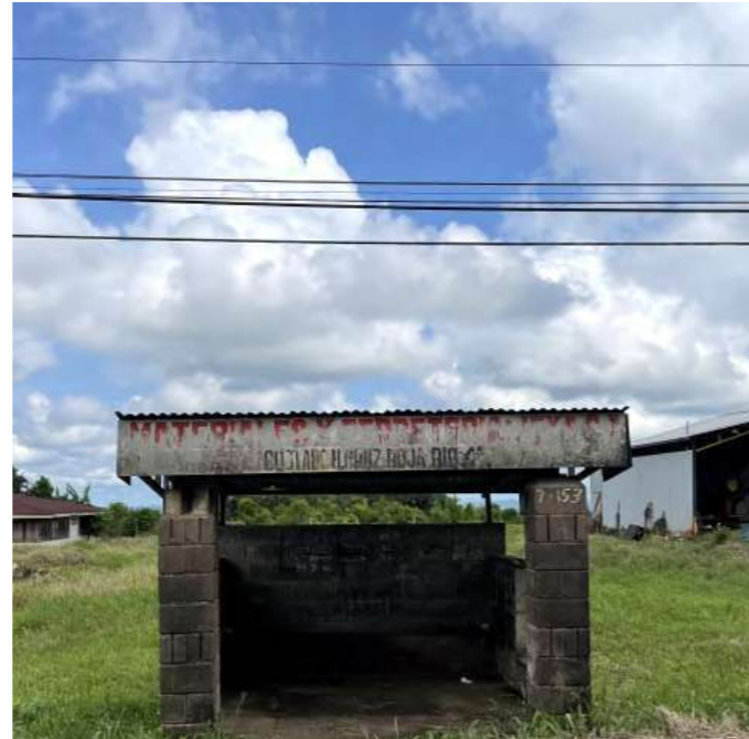
Figura 28. Mal estado de la infraestructura urbana Fuente: Propia.
