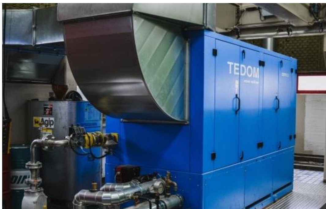
Figura 7 Equipo de cogeneración TEDOM Cento 200
