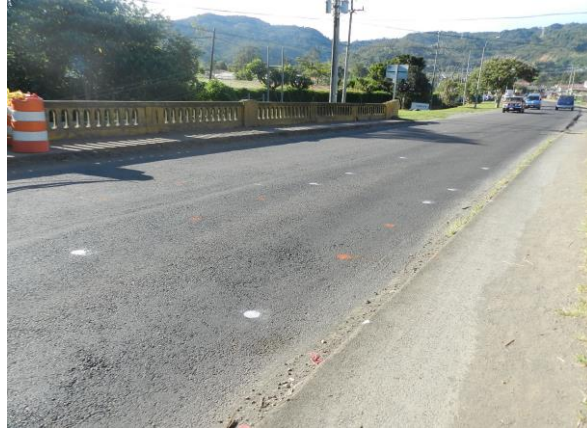
Figura 56. Demarcación sobre el puente Purires.
