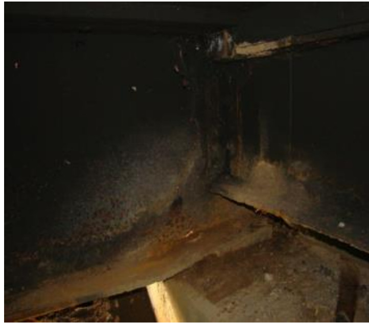
Figura 9. Fotografía del deterioro por corrosión cercano a los apoyos
