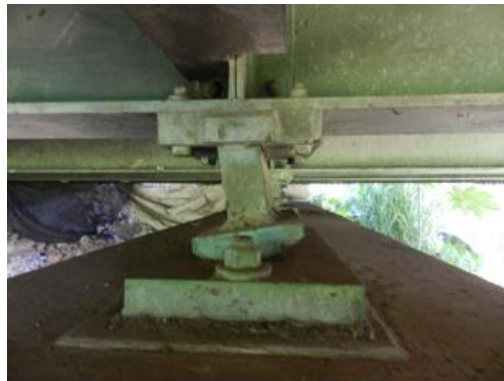
Figura 7. Fotografía de apoyo intermedio del puente piloto, puente “Purires”, con problemas de desplazamiento
