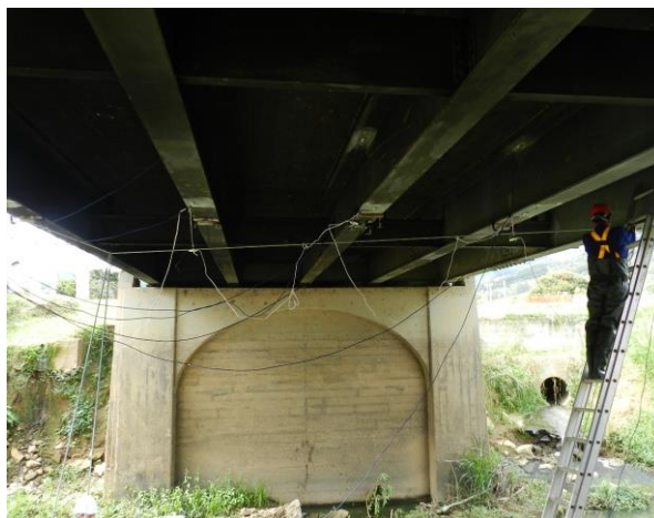
Figura 64. Tramo central del puente con sensores
