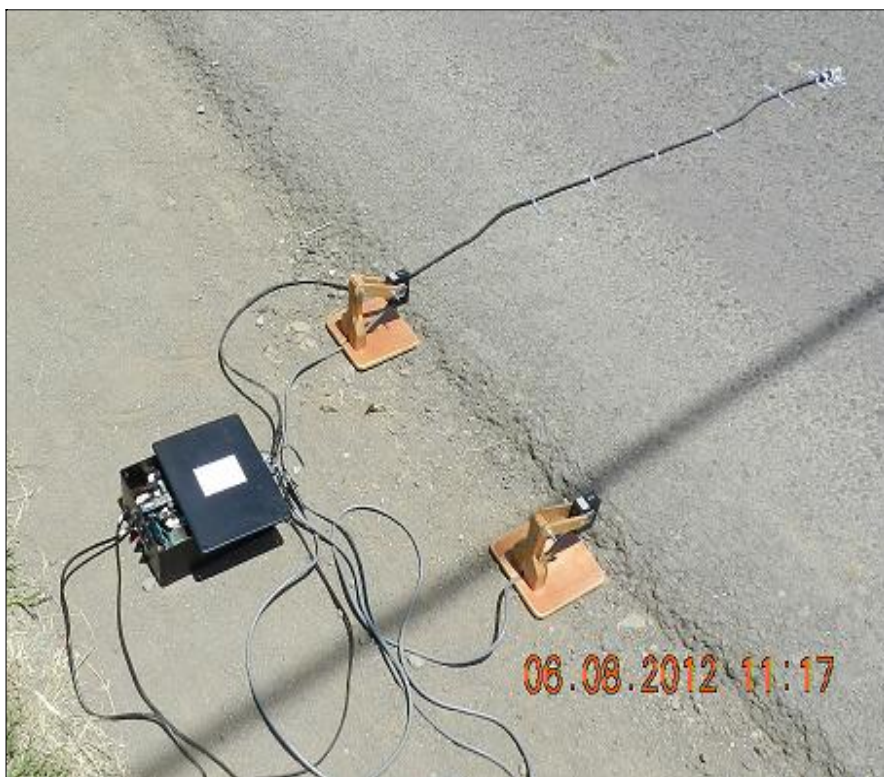
Figura 55. Muestra de instalación de los sensores en una vía de tránsito
