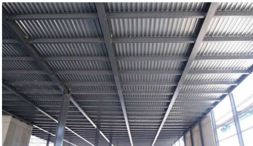
Figura 118. Fotografía de un entrepiso metálico con lámina ondulada. Fuente: igesur.com
