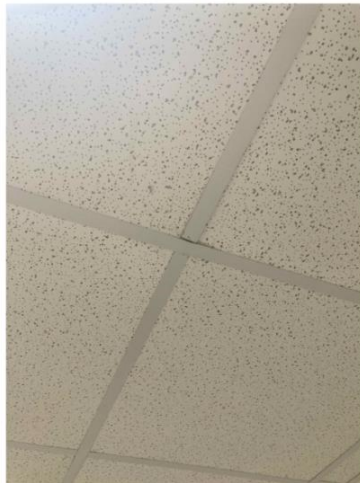
Figura 24. Evidencia fotográfica del defecto identificado.
