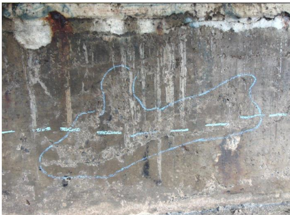
Figura 25. Descaramiento y grietas en bastión.
