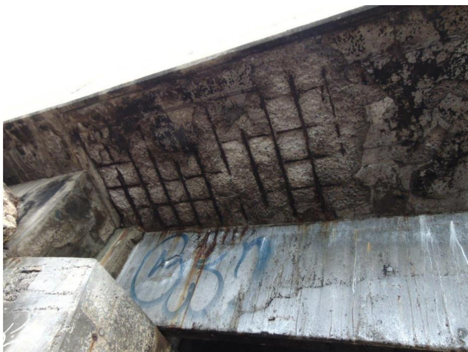
Figura 21. Acero de refuerzo expuesto en losa.
