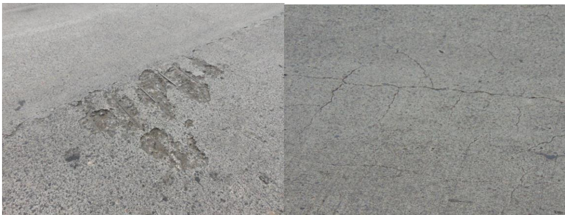
Figura 20. Desprendimiento del concreto, acero expuesto y grietas losa.
