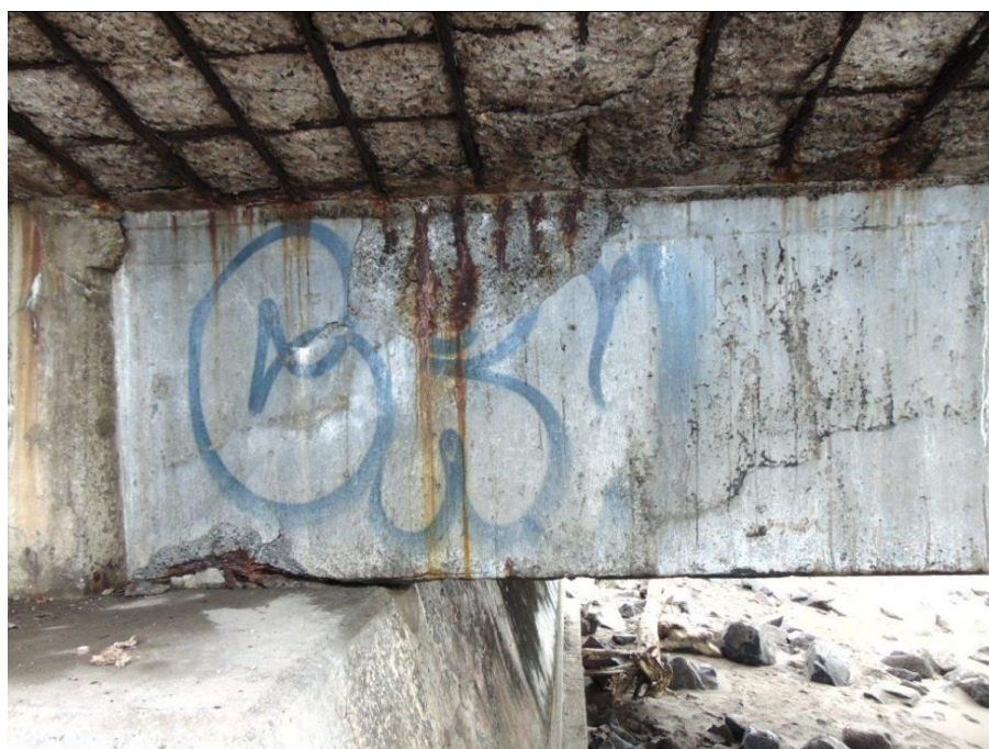
Figura 23. Acero expuesto en viga en zona de apoyo.
