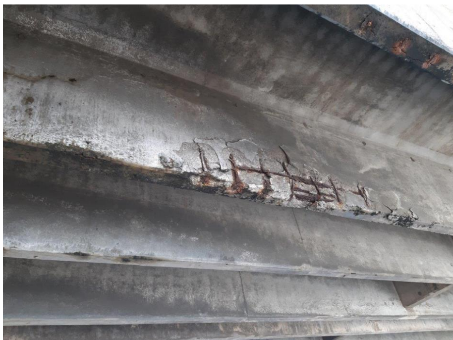
Figura 22. Descascaramiento del concreto y acero expuesto en viga.
