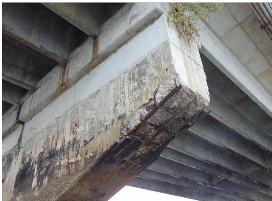
Figura 24. Desprendimiento del concreto y acero expuesto en martillo de la pila.
