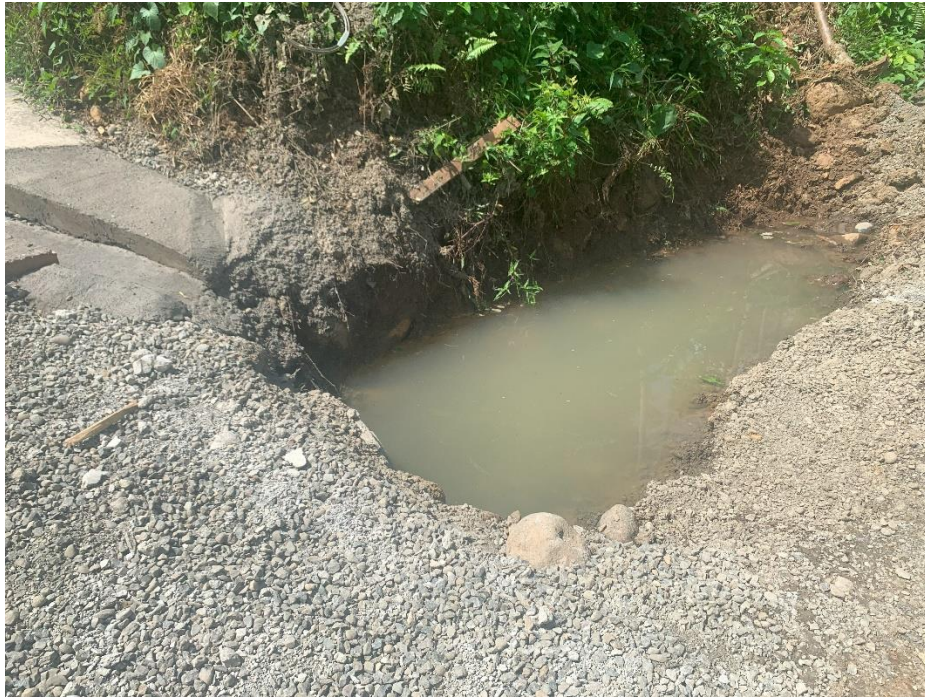
Informe 12. Figura 2. Problema de estancamiento de agua de debido a ausencia de cuneta para desalojo de agua de lluvia
