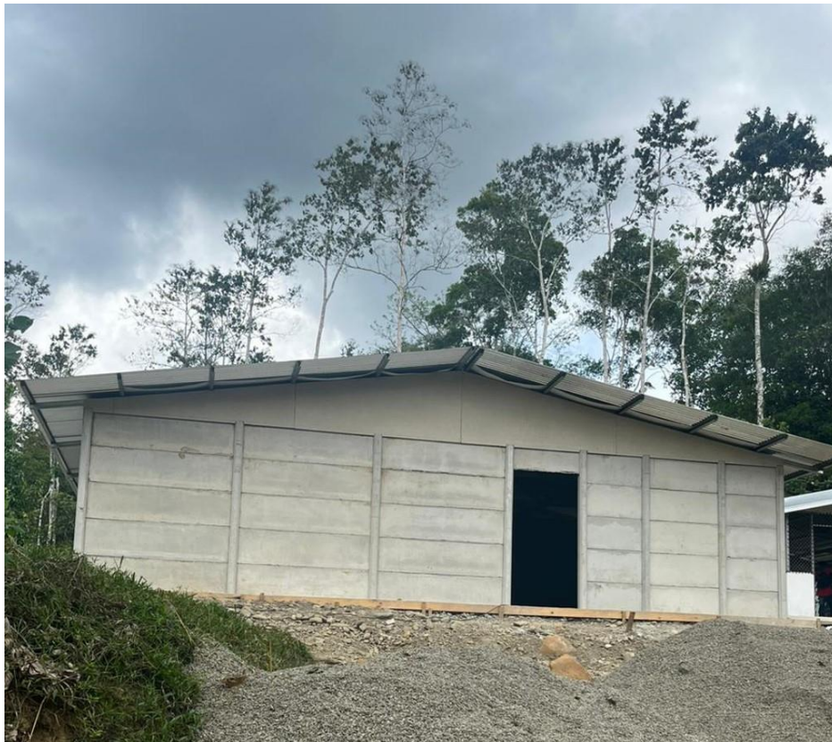
Informe 7. Figura 1. Vista de fachada principal de área de procesamiento, colocación de zinc y aislante térmico
