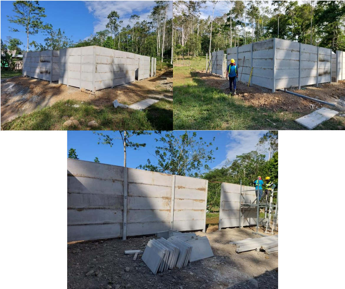
Informe 4. Figura 2. Vista Externa de Levantamiento de Columnas y Paredes de Estructura Principal
