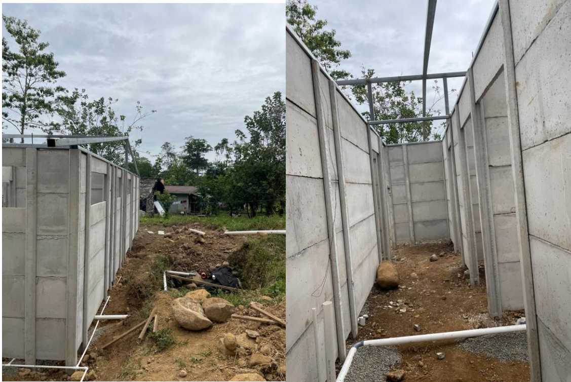
Informe 5. Figura 2. Instalación de cerchas, sistema hidráulico y mecánico en área de procesamiento
