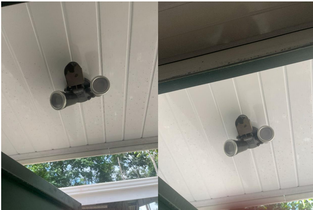
Informe 14. Figura 6. Corrección de lampara sentido de lampara
