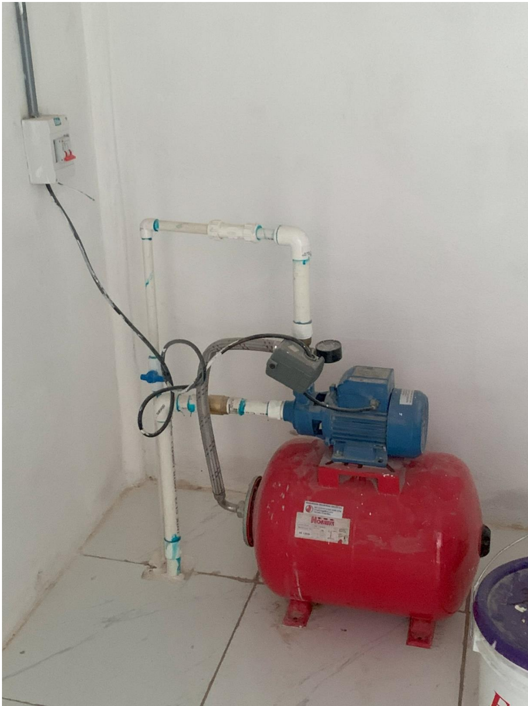
Informe 13. Figura 1. Conexión de bomba hidráulica dentro del área de procesamiento
