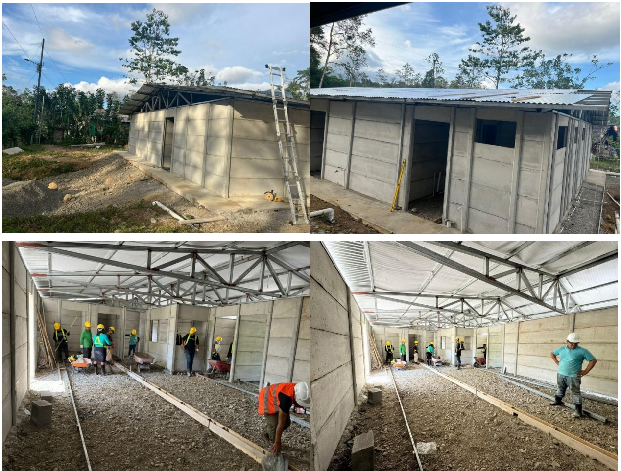
Figura 15. Primera etapa de construcción del área de acopio del centro de manejo de postcosecha de cacao en el territorio indígena Tayní, Valle La Estrella, Limón.
