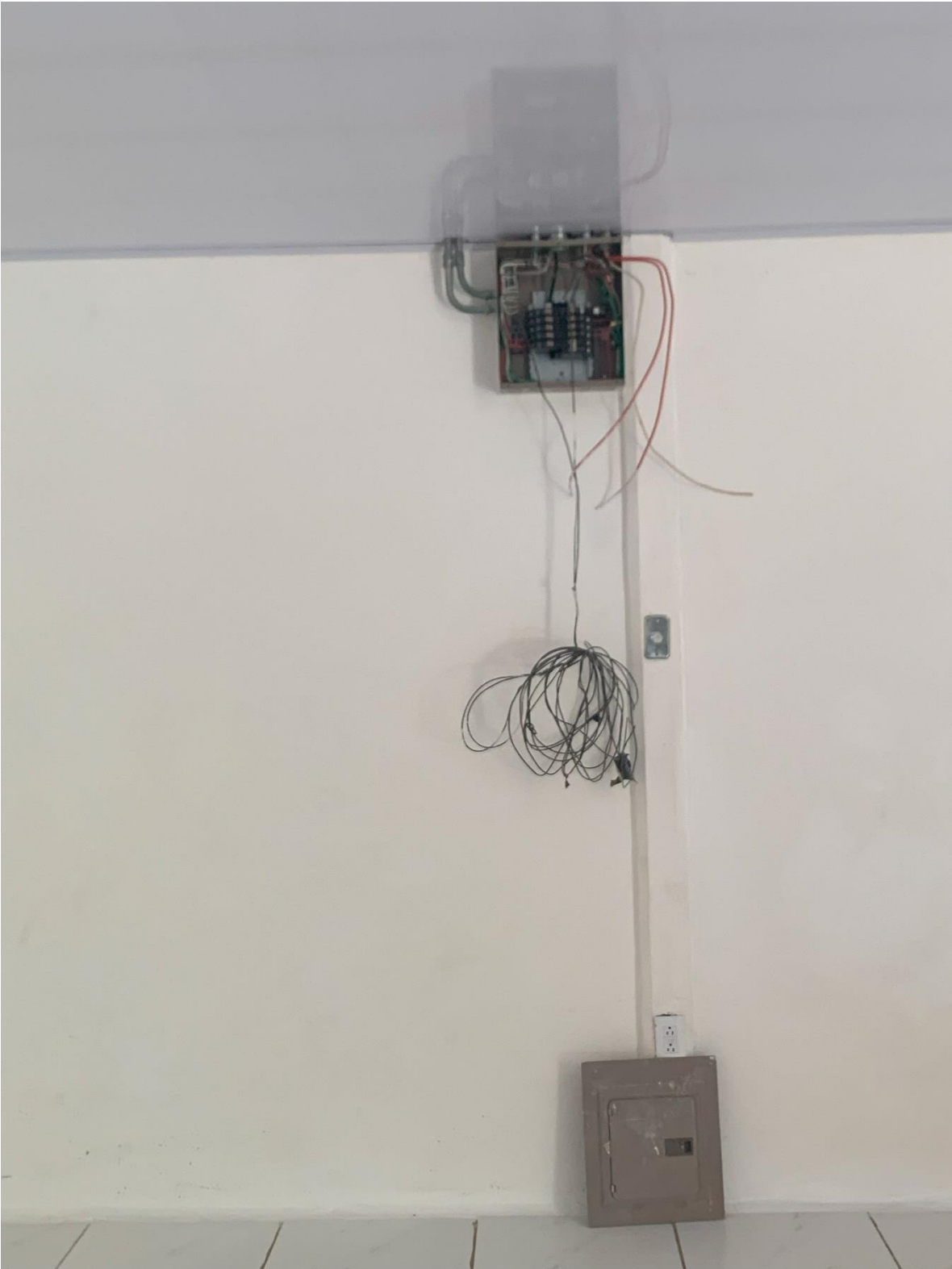
Informe 13. Figura 2. Pendiente conexión de caja de breaker
