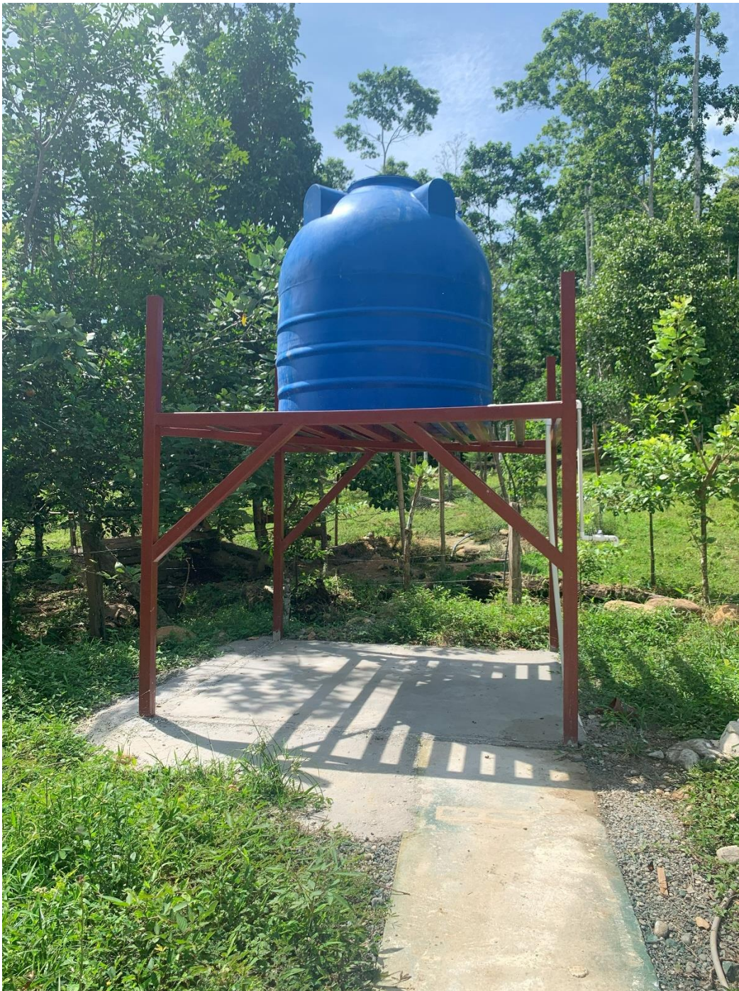
Informe 12. Figura 3. Pintado de plataforma del tanque de almacenamiento de agua, y funcionamiento de sistema de agua del proyecto
