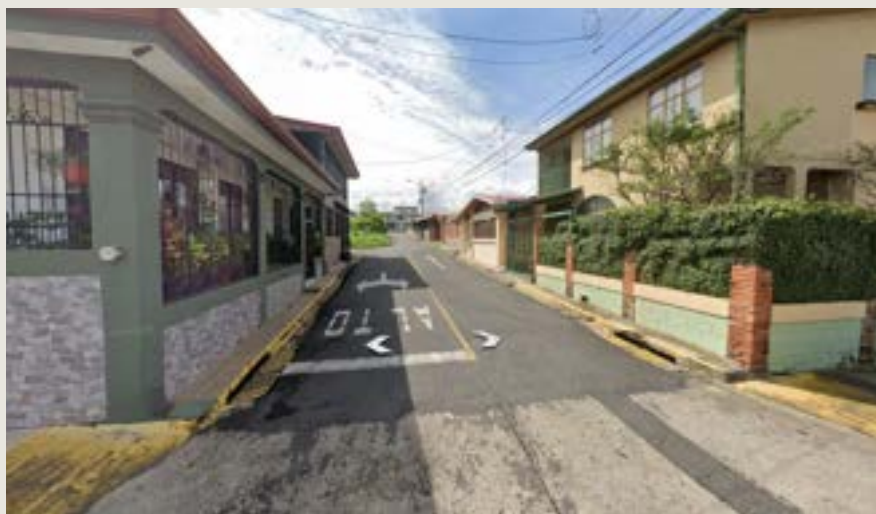
Figura 85 Dimensión de incorrecta de aceras y rampas que representan un peligro. Nota. Tomado de Google Maps. (2021). Google Maps. Google Maps. https://www.google.com/maps/
