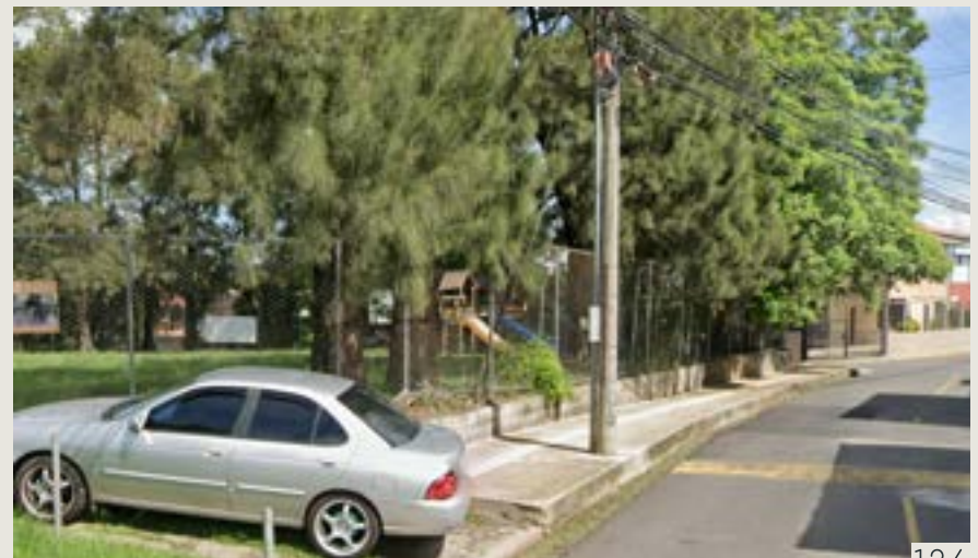
Figura 84 Discontinuidad de pavimentos con losa podotáctil y obstrucción de la misma Nota. Tomado de Google Maps. (2021). Google Maps. https://www.google.com/maps/
