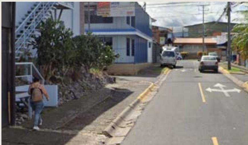
Figura 83 Desgaste en las aceras de Los Lagos Nota. Tomado de Google Maps. (2021). Google Maps. https://www.google.com/maps/
