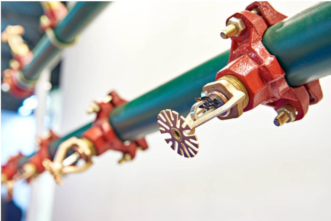
Figura 3. Sistema de Rociadores. Fuente: Namtech
