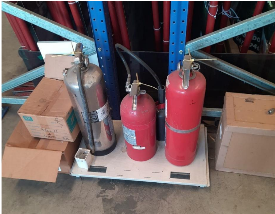
Figura 6. Batería de Extintores ABC Presente. Fuente: Elaboración propia
