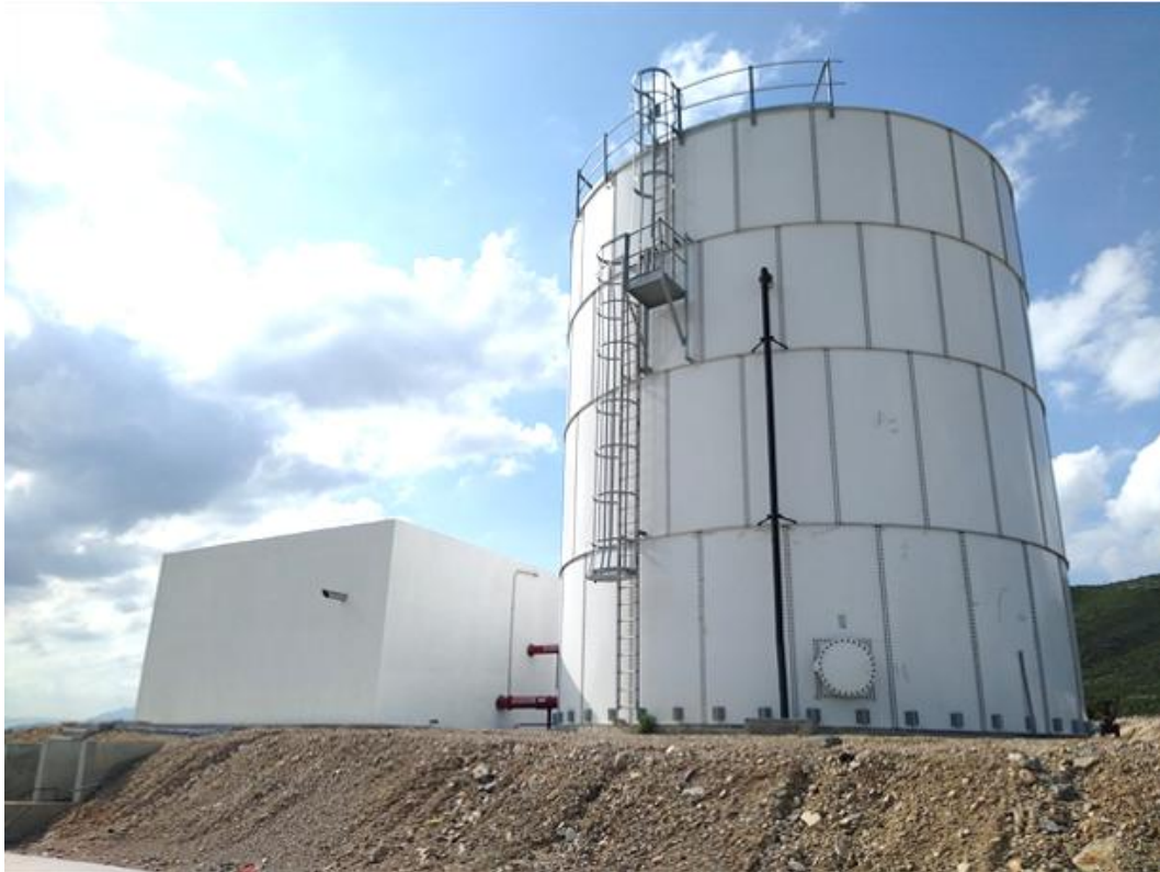
Figura 4. Tanque de Almacenamiento. Fuente: Alliance Specialized Systems
