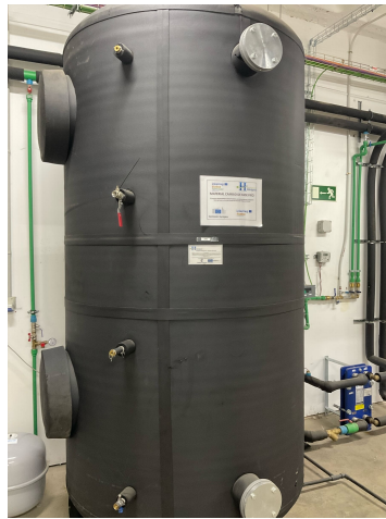
Figura 7.9: Tanque de almacenamiento de frío
