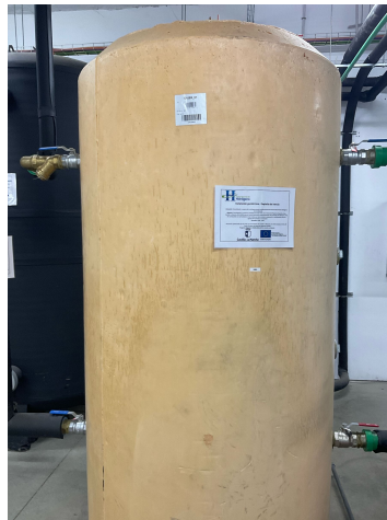
Figura 7.7: Tanque de inercia
