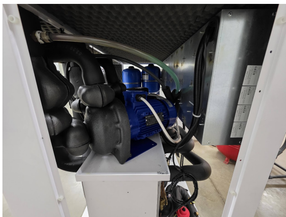
Figura 7.6: Bomba de calor geotérmica
