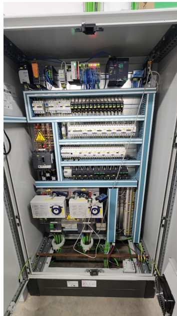
Figura 7.19: Gabinete de conexiones
