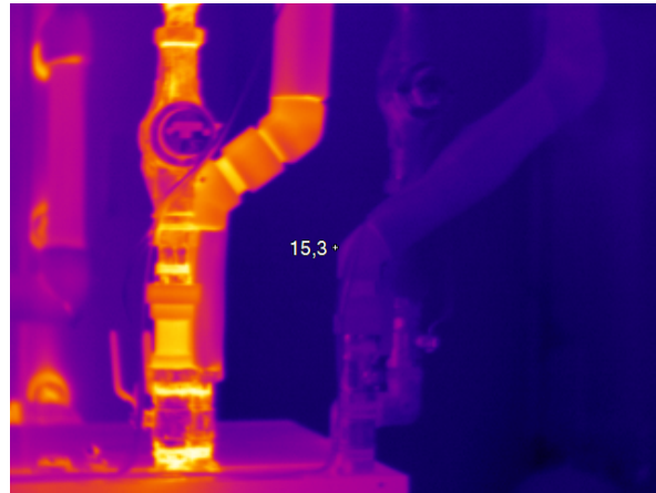
Figura 7.39: Vista térmica de bomba de calor geotérmica
