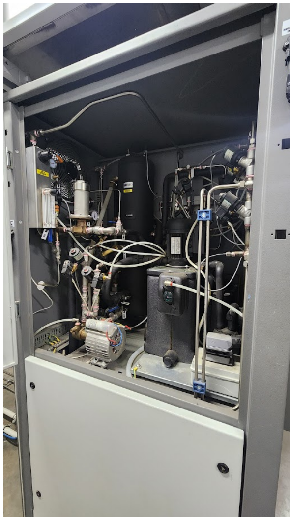
Figura 7.25: Refrigeración integrada de Electrolizador
