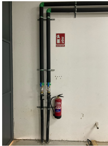
Figura 7.3: Entrada y Retorno a Pozo Geotérmico
