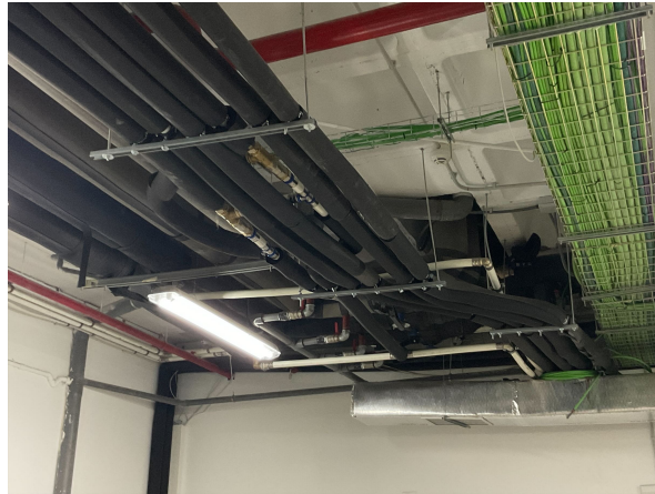
Figura 7.11: Tuberías a sala de Electrolizador y Pila
