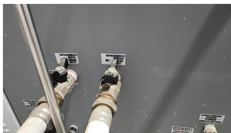
Figura 7.26: Refrigeración integrada de Electrolizador
