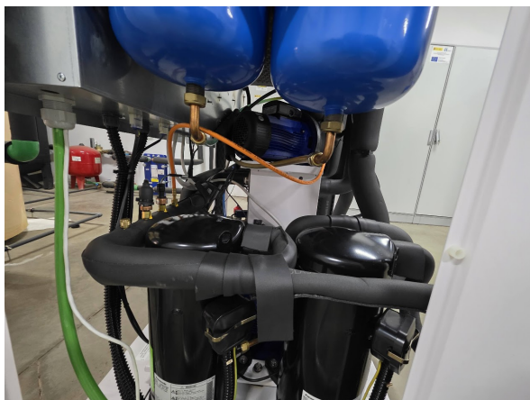
Figura 7.5: Bomba de calor geotérmica
