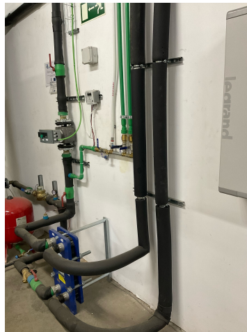
Figura 7.10: Intercambiador de almacenamiento de frío
