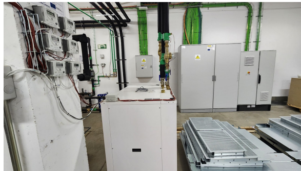
Figura 7.4: Bomba de calor geotérmica
