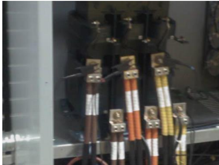
Ilustración 10. Bobinas Inductivas de Filtro de Armónicos.
