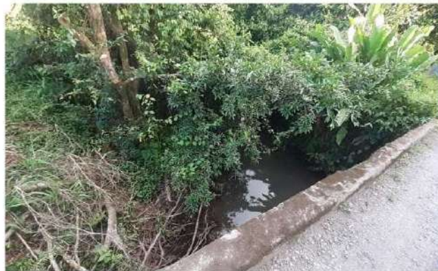
Figura 21. Cauce de río con presencia de árboles y troncos (Condición 4).
