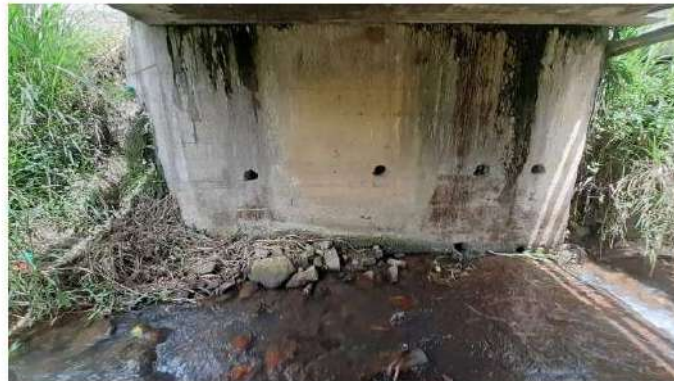
Figura 37. Vista de los indicios de inundaciones
