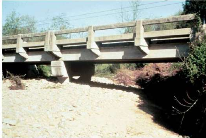
Figura 18. Agradación del cauce.
