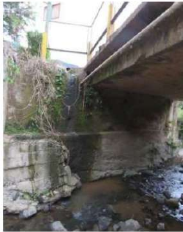
Figura 26. Descarga de alcantarillado en el puente (Condición 3)
