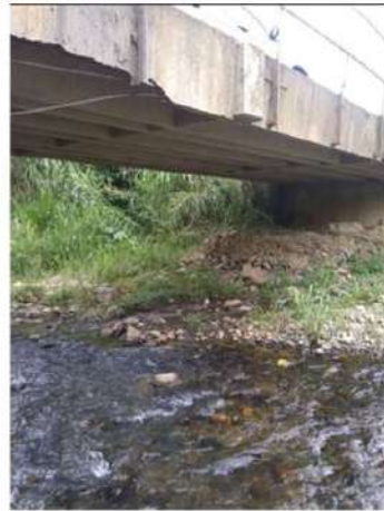
Figura 14. Indicios de inundación: daños en la subestructura.
