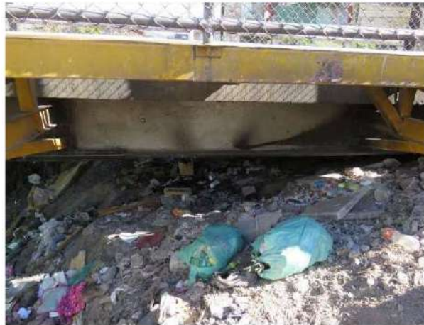
Figura 24. Cauce de río presencia importante de basura (Condición 3)
