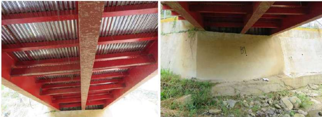
Figura 15. Indicios de inundación: manchas de lodo en la superestructura y subestructura.
