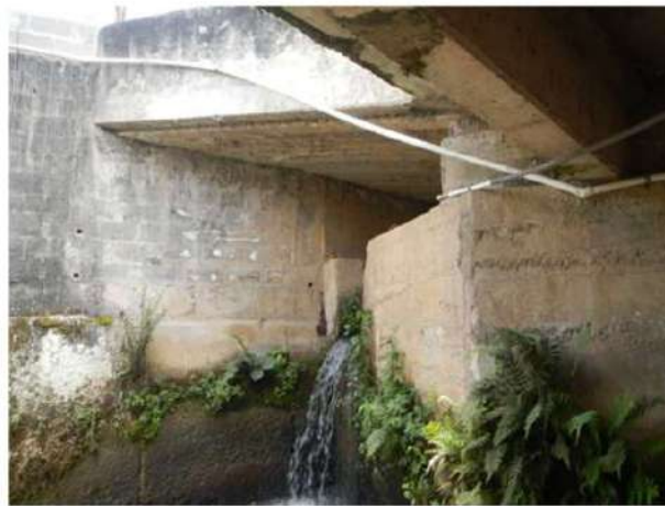
Figura 27. Descarga de alcantarillado en el puente (Condición 3)
