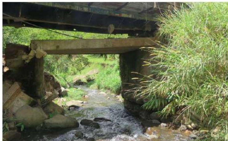
Figura 29. Presencia de estructuras en el cauce (Condición 3)
