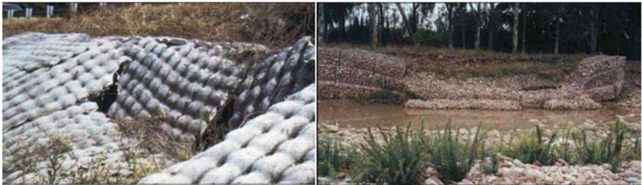
Figura 20. Daños graves en las protecciones de los márgenes.
