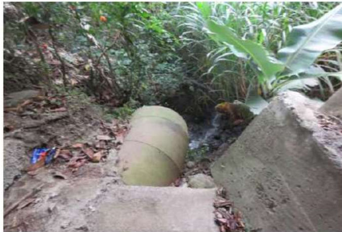
Figura 28. Descarga de alcantarillado en el puente (Condición 4)
