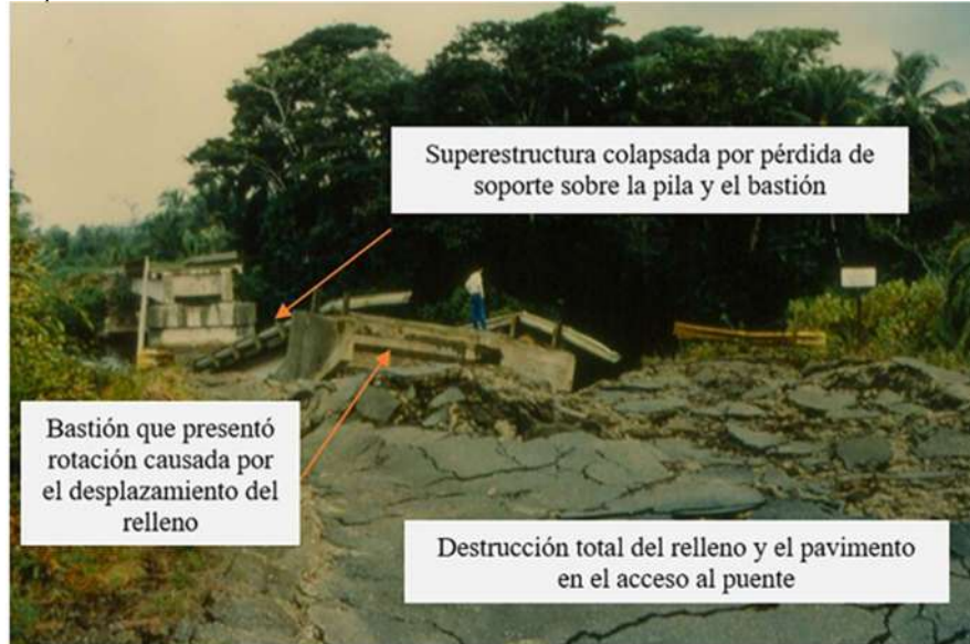
Figura 12. Daños en el puente sobre el río Bananito ruta 36 en el Terremoto de 1991
