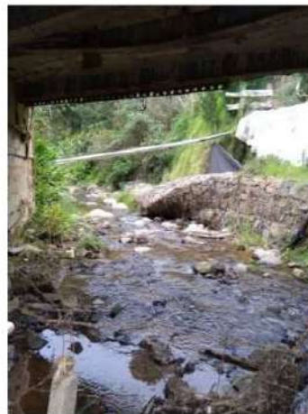
Figura 11. Protecciones de margen tipo gaviones fallido (Condición 4)
