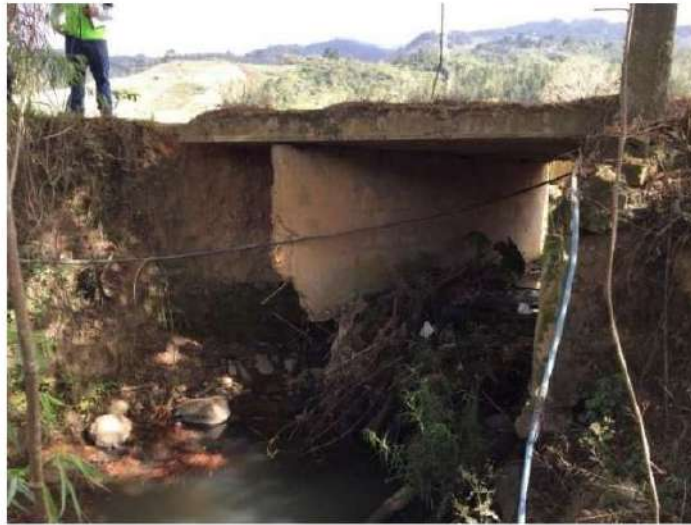
Figura 20. Cauce de río con presencia de escombros de vegetación (Condición 4).
