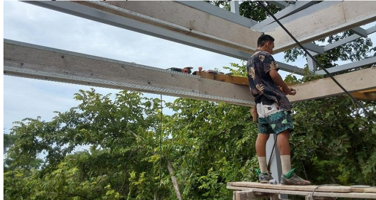
Figura 7. Ejemplo de falta de seguridad ocupacional
