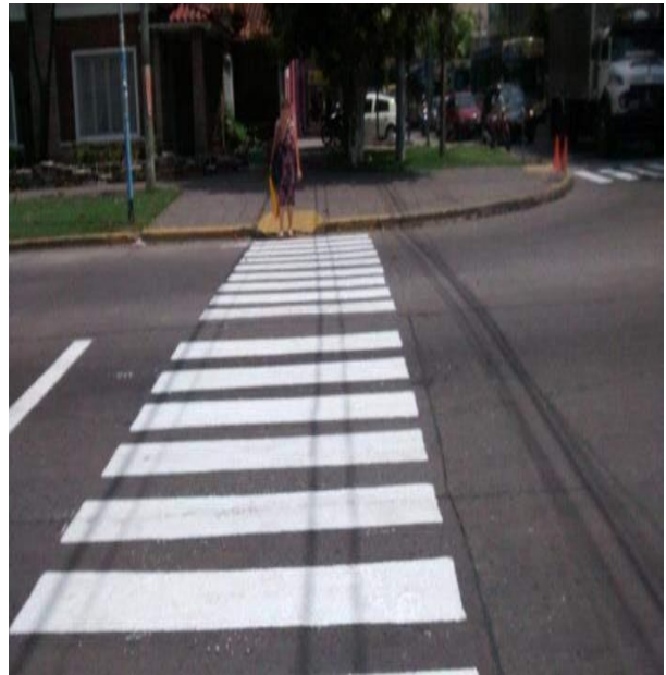
Figura 39. Cruce peatonal sin semáforo
