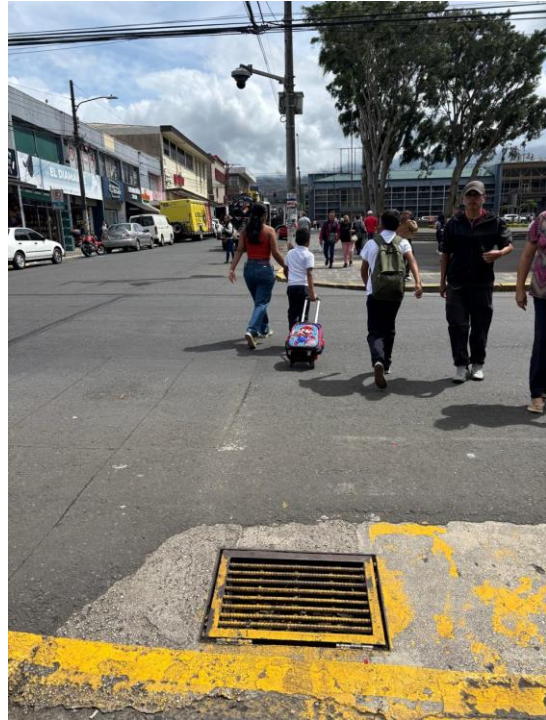
Figura 34. Señalización horizontal ausente
