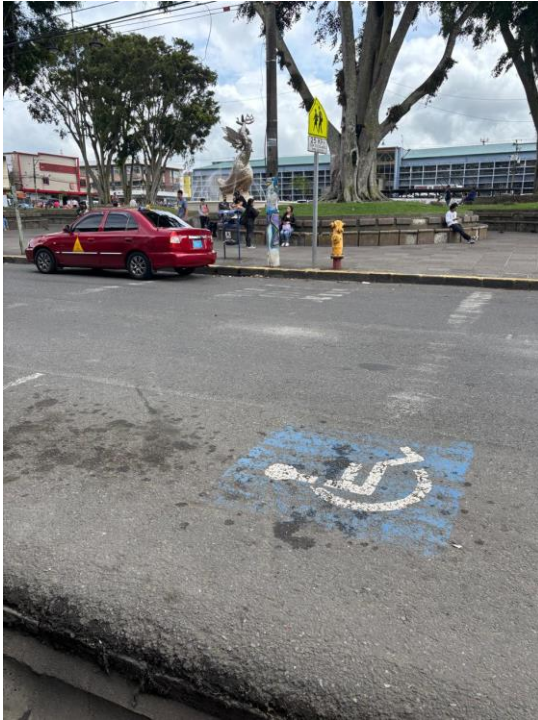
Figura 33. Señalización horizontal desgastada
