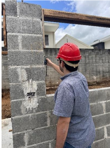
Figura 61. revisión del plomado de la pared de la vivienda 27.
