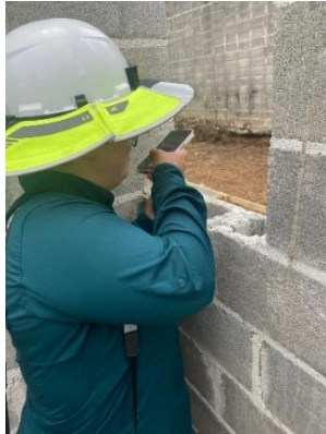
Figura 60. Revisión del relleno de celdas de los bloques de la pared de la vivienda 27.
