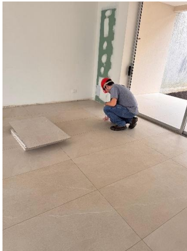
Figura 66. Revisión del enchape de pisos de la vivienda 55.
