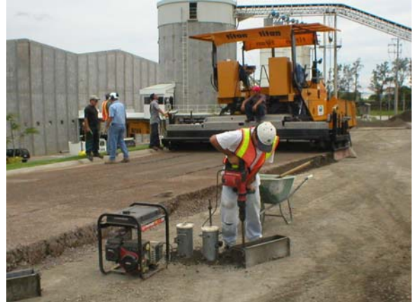
Figura 2: Etapa 4, prueba escala natural, colocación en situ de las mezclas probadas en el laboratorio.
