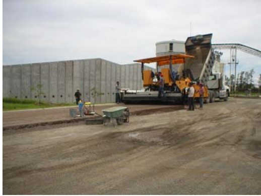
Figura 32. Movimiento en conjunto de la maquinaria para la colocación de la mezcla de CCR
