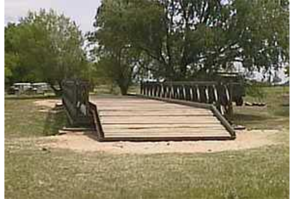
Fig. N° 5: Vista de un puente a base de armaduras con piso inferior y tablero de madera. MSPAINT
