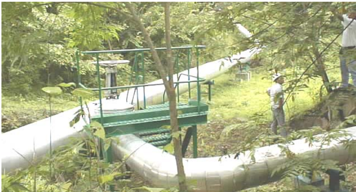
Figura 11 Tubería de conducción de fluidos de reinyección. Nótese la válvula de bifurcación hacia un pozo de apoyo. (Imagen JPG).
