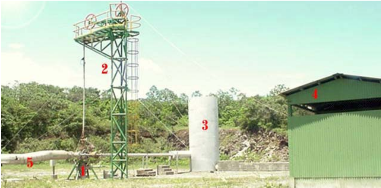
Figura 3 Pozo Productor. Se aprecia el sistema de control del pozo (1), la torre de inhibición de \text{CaCO}_3 (2), el silenciador (3), control del sistema de inhibición, y la tubería que conduce los fluidos bifásicos hasta la unidad de separación. . (Imagen JPG).
