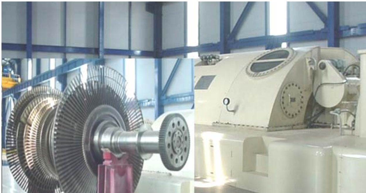
Figura 13 Turbina utilizada en la Planta Miravalles I. A la izquierda la imagen de la turbina que alimenta al generador a la derecha la turbina que se encuentra instalada. (Imagen JPG).
