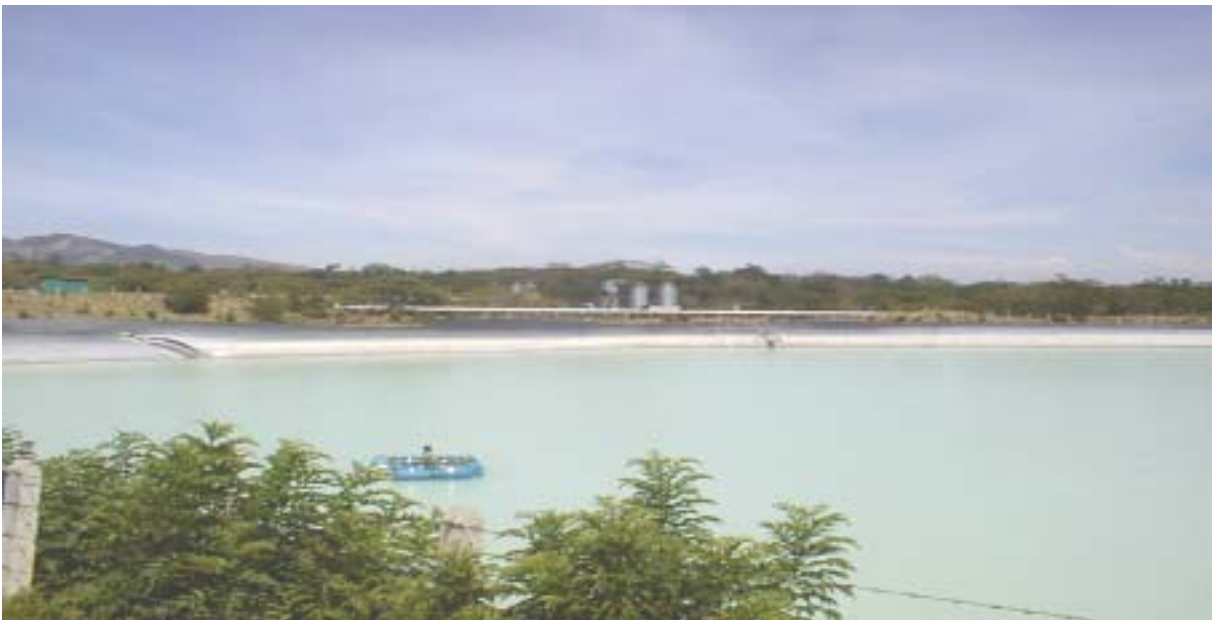
Figura 9 Laguna de precipitación. Al fondo se pueden apreciar los silenciadores de una de las unidades de separación y una de las líneas de inyección en caliente presentes en el Campo Geotérmico Miravalles. (Imagen JPG).
