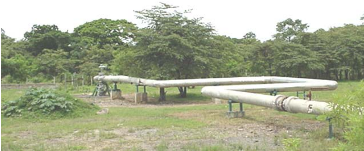
Figura 10 Omega horizontal en el sistema de acarreo de fluidos (Tubería de Inyección en Caliente). Nótese el tipo y la distancia de los soportes empleado para suspender la tubería. (Imagen JPG).
