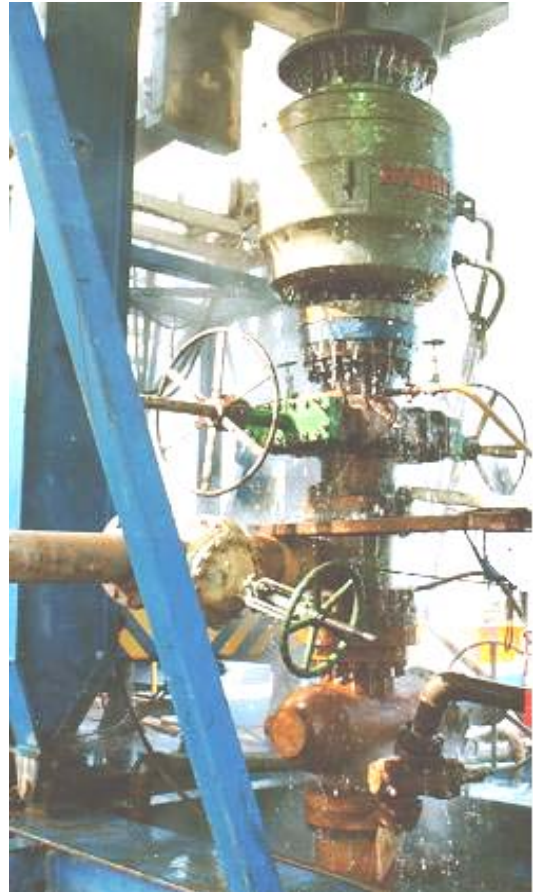
Figura 22 Sistema de preventores del pozo. Permite controlar el pozo. (Imagen JPG).
