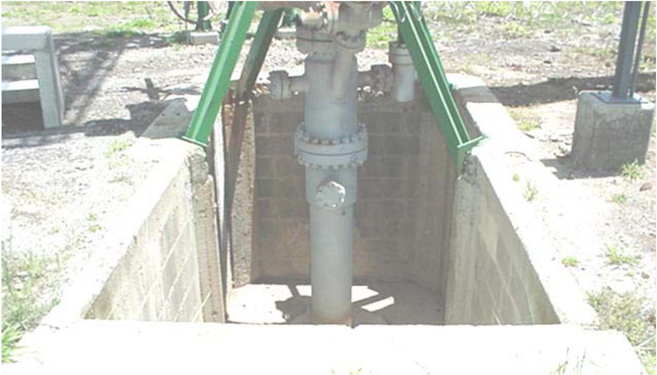
Figura 15 Contrapozo. Nótese el sistema utilizado para unir el ademe con el cabezal de válvulas para el control del pozo. (Imagen JPG).
