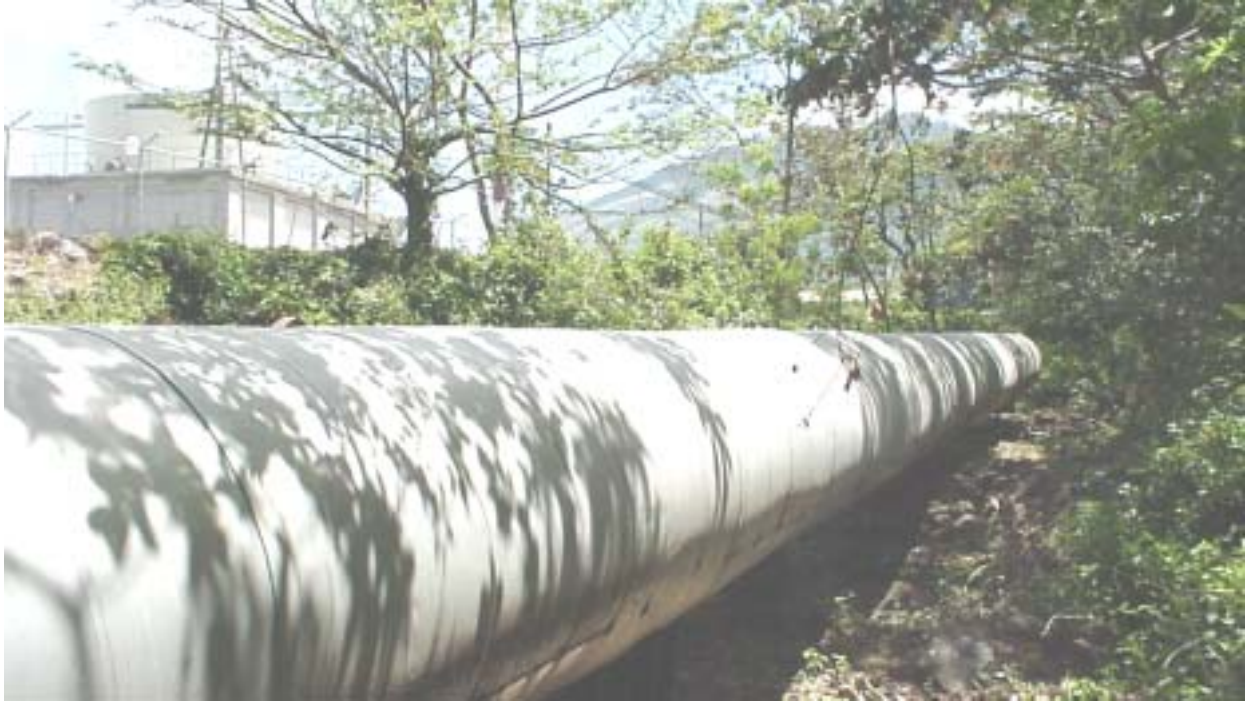
Figura 8 Tubería de conducción de vapor (Vaporducto). En el plano superior izquierdo puede apreciarse parte de las torres de enfriamiento pertenecientes a la unidad Casa de Máquinas II. (Imagen JPG).
