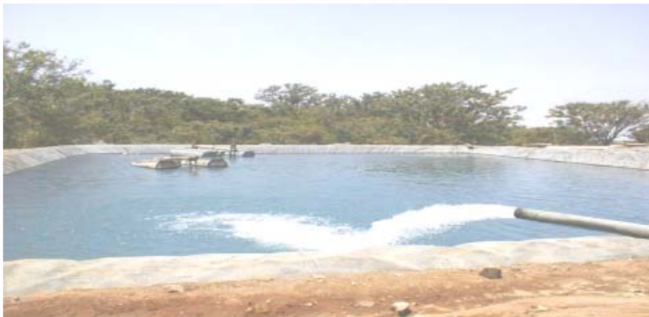
Figura 18 Laguna para el almacenamiento de agua en la plataforma. Se puede apreciar la geomembrana de impermeabilización de la laguna. (Imagen JPG).
