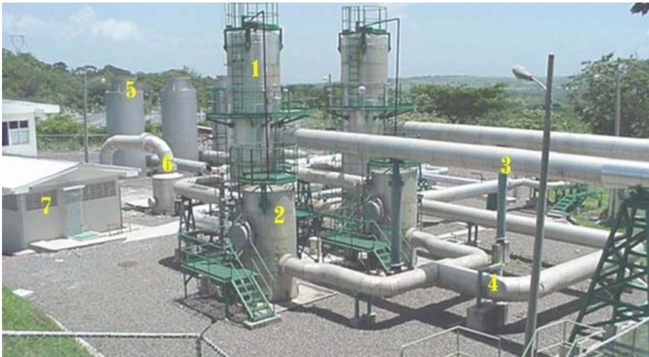
Figura 4 Unidad de separación (Satélite). Nótese los componentes del sistema. Separadores ciclónicos (1), los tanques que recolectan el agua separada (2), tuberías de bifásico procedente de los pozos productores (3), tuberías de inyección en caliente (4), silenciadores (5), tubería de conducción de vapor (6) y las unidades de control automático del sistema (7). (Imagen JPG).
