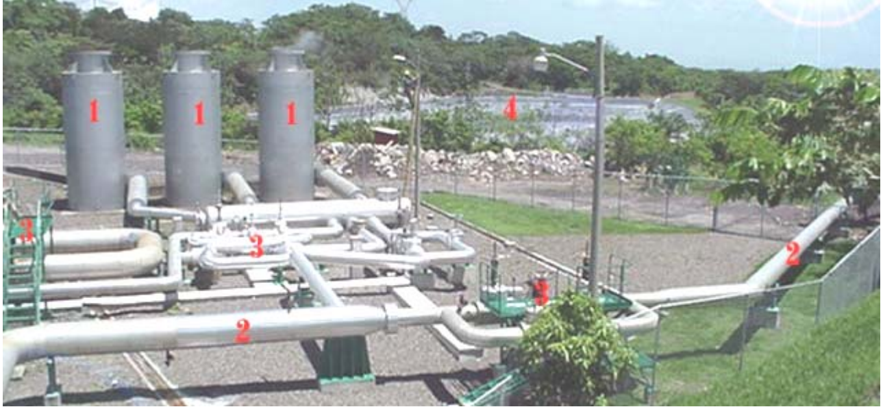
Figura 5 Sistema de tuberías de control en las unidades de separación. (1) Sistema de silenciadores, (2) tubería de conducción de aguas de reinyección, (3) válvulas de control del fluido, (4) laguna de sedimentación. (Imagen JPG).
