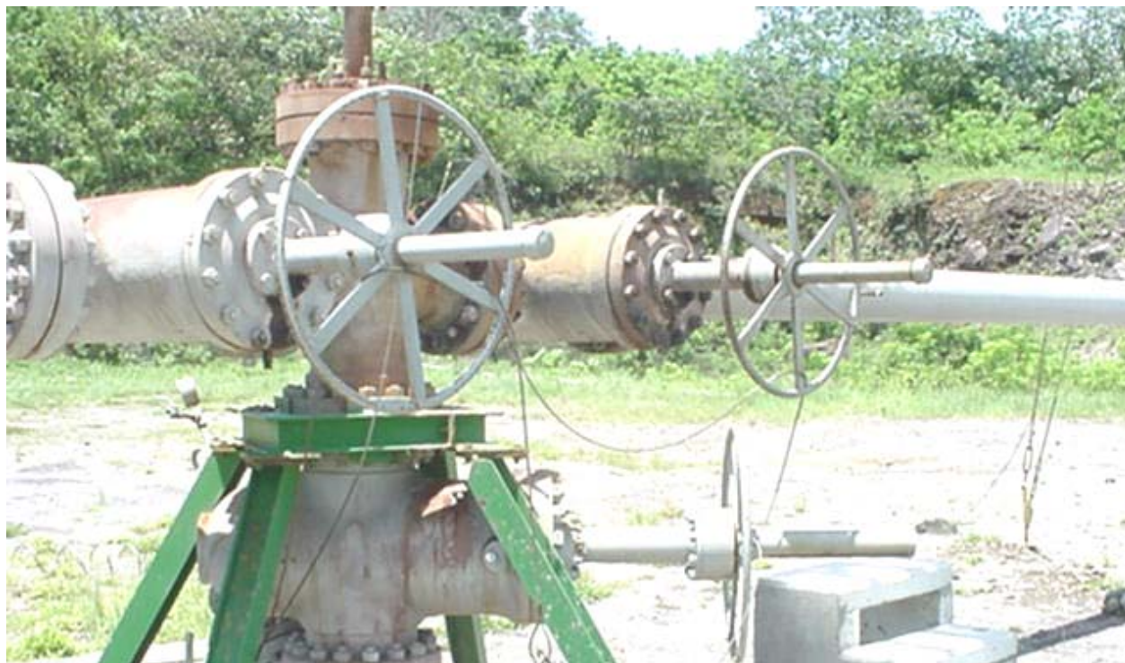
Figura 17 Sistema de válvulas de control del flujo del pozo. En la parte inferior la válvula maestra o principal, a la izquierda la válvula que regula el flujo hacia las unidades de separación, a la derecha la válvula que controla el flujo hacia el silenciador. (Imagen JPG).
