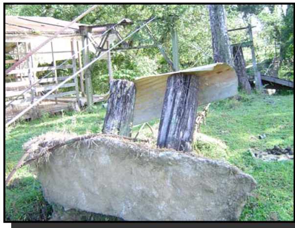
Foto 8 Aspectos de vulnerabilidad de la tubería de conducción y tramos colgantes, daños causados por inundaciones frecuentes en el río Puerto Viejo.
