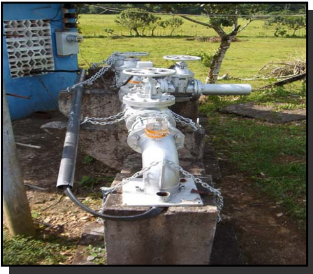
Foto 6 Estación de Bombeo La Guaría
