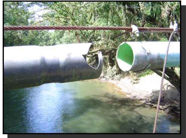
Foto 1 Cauce del Río Puerto Viejo, Tubería de conducción reventada por aumento de nivel del cauce.
