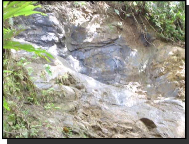
Foto 2 Deslizamiento en zona de Tubería de Conducción
